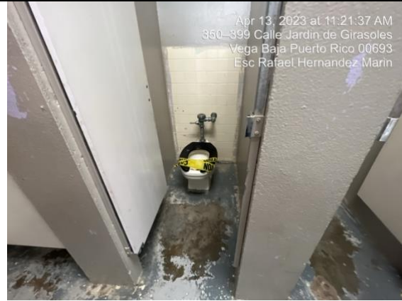
Baño niñas frente al comedor - inodoro suera de servicio
