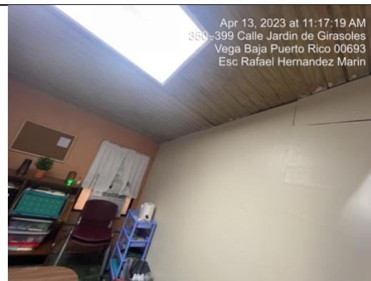
Salón psicología y terapia Filtración al llover debido a grieta en el techo
