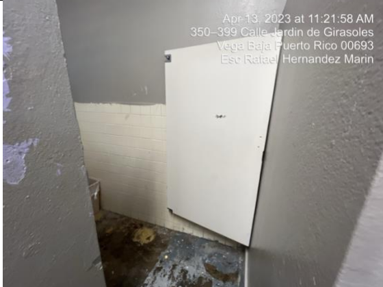
Baño niñas frente al comedor - puertas no cierran
