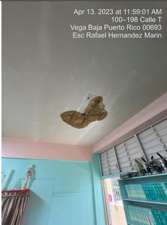
Salón 4to segundo nivel Sra Martínez – Varilla expuesta, luminaria ausente, 1 cover de luminaria ausente y 5 operadores de ventana
