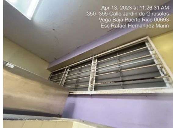
Comedor – requiere instalación de 20 operadores de ventana
