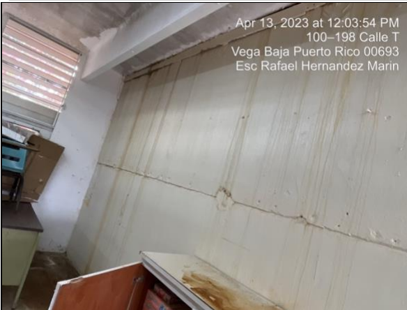
Salón el palomar – filtració severa, lavado de presion, primer, pintura
