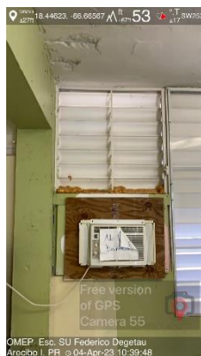
Ilustración 15. Ventanas Miami para cambiar
