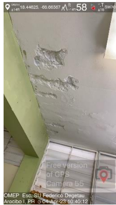
Ilustración 19. Varillas Expuestas para Empañetar en Edif.H
