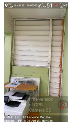
Ilustración 16. Ventanas Miami para cambiar
