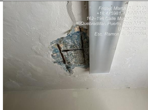
Ilustración 10. Trabajos de empañetados (incluir despegue de material suelto y tratamiento para acero)
