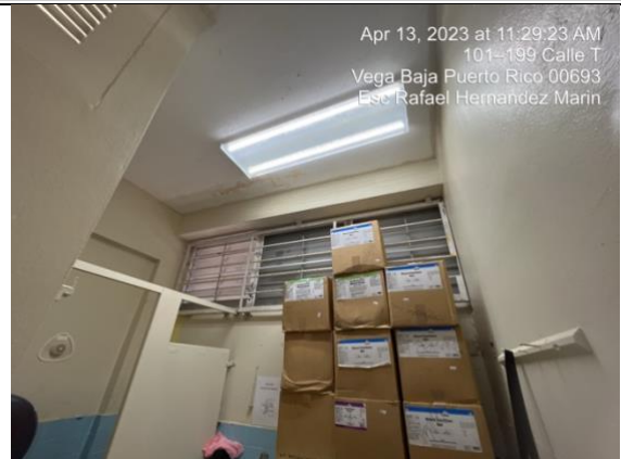
Comedor – Reparación de ventanas que no habren
