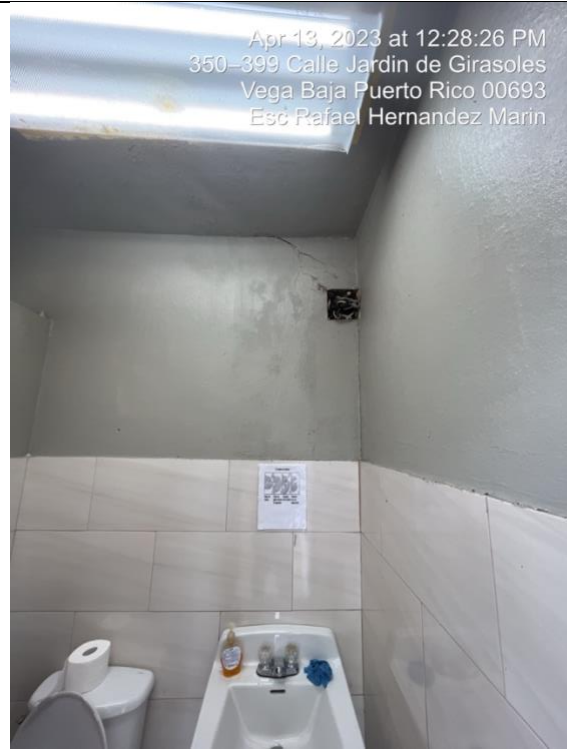
Salón Kinder 2 baños – hueco con cables expuestos, inodoro dañado
