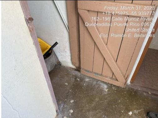
Ilustración 11. Puertas en Madera dañadas
