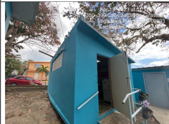
Salón psicología y terapia - reemplazo de puerta dañada
