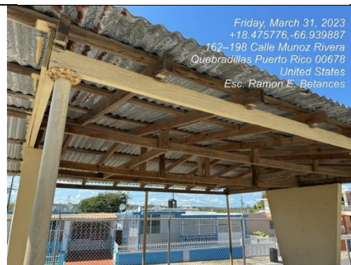
Ilustración 16. Techos de zinc deteriorados
