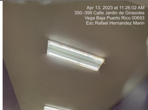
Comedor – Filtración de techo
