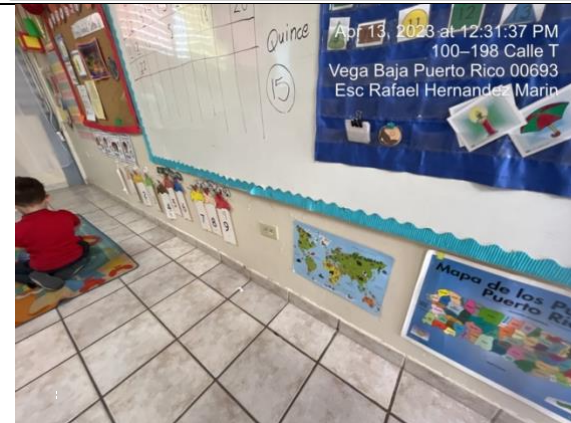
Salón Kinder Sra Otero – receptaculo dañado
