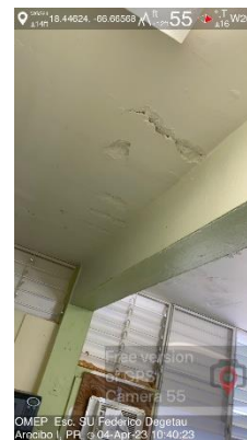
Ilustración 18. Varillas Expuestas para Empañetar en Edif.H
