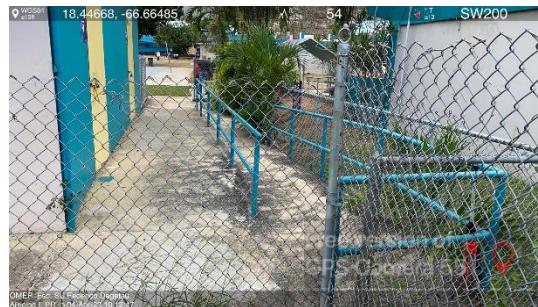
Ilustración 10. Verja Eslabonada para reparar en la esquina Noroeste del Edif.O
