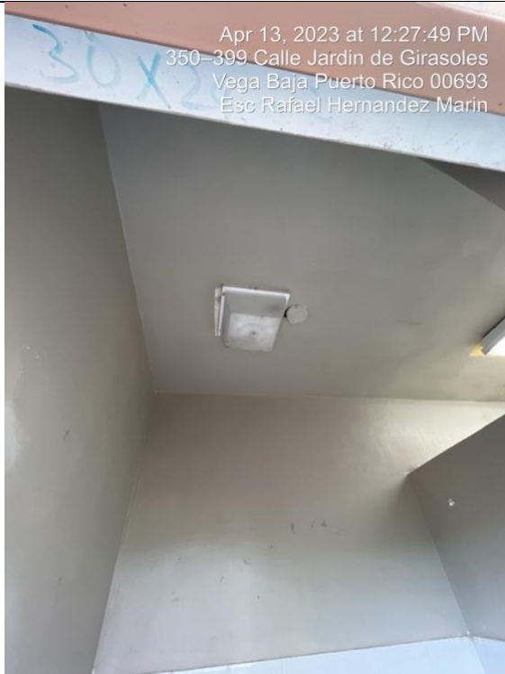
Salón Kinder 2 baños – foco fundido
