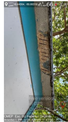
Ilustración 20. Varillas Expuestas para Empañetar en Exterior del Edif.D
