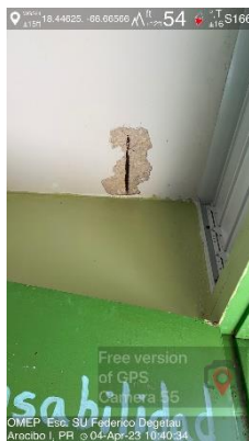
Ilustración 17. Varillas Expuestas para Empañetar en Edif.H
