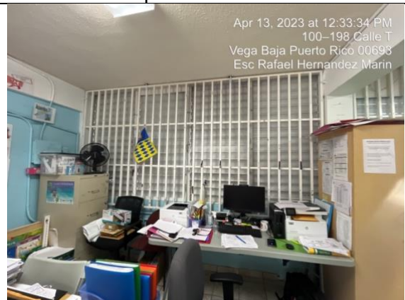
Salón Educación Especial – 2 ventanas nuevas mal instaladas, 8 ventanas no abren, 8 screen plastico
