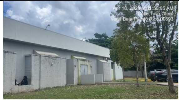
Teatro – alumbrado dañado, aire acondicionado
