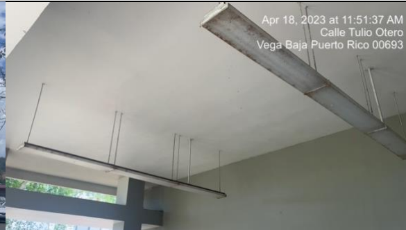
Pabellón A 039 – alumbrado dañado
