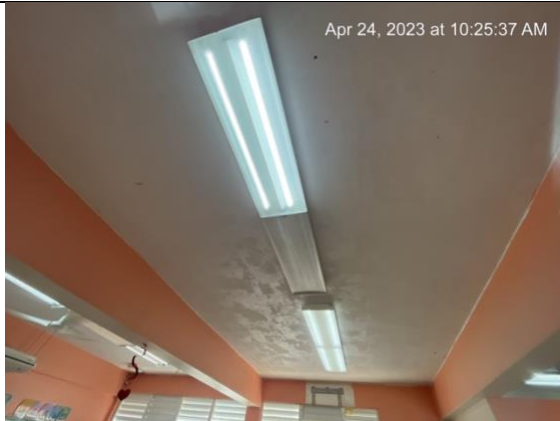
Salón de Kínder – 3 luminaria, 9 operadores de ventana
