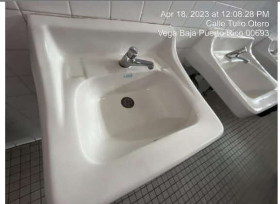
Baño hembras tercer nivel – llaves de lavamanos sueltas
