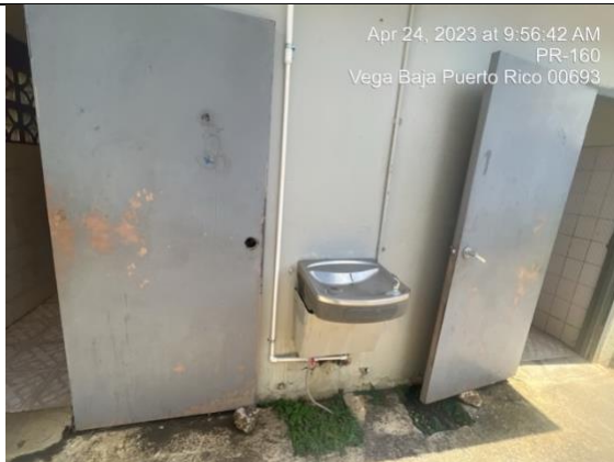
Puertas de baño – reemplazo de 2 puertas dañadas
