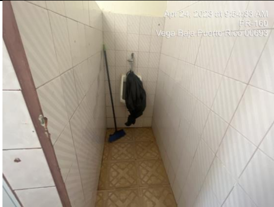
Baño de varones – urinal dañado
