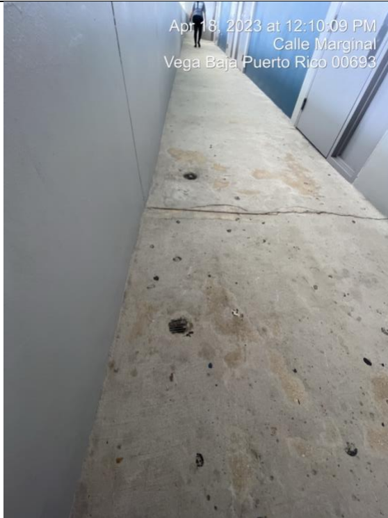
Pasillo frente a comercio C303 – desagües tapados
