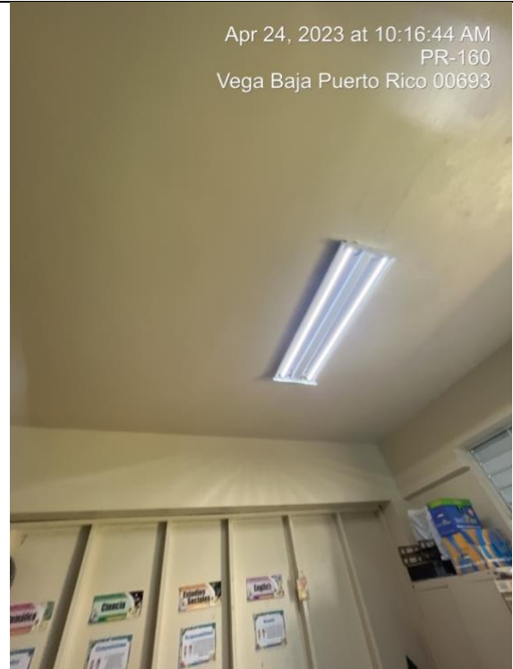
Salón Educación Especial – luminaria, 1 pizarra, 1 aire acondicionado, 1 abanico, 1 receptáculo dañado, 4 operadores de ventana, 4 screen plástico de ventana y 1 puerta de screen
