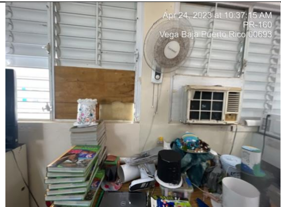
Salón ciencia octavo – 2 aires acondicionado de ventana, 1 alumbrado, 10 screen plástico de ventana, 10 operadores de ventana, 2 puertas de screen
