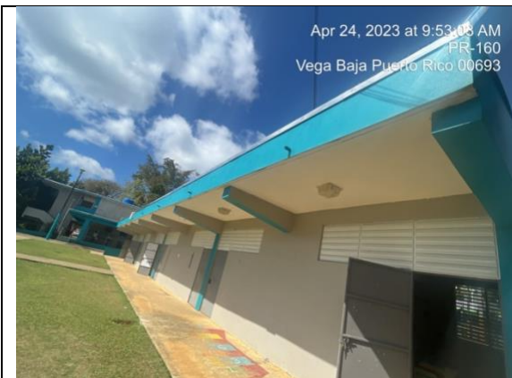
Pasillos – Focos exteriores
