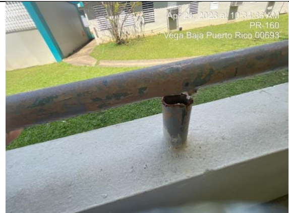
Pasillo frontal salón de kínder – barandal suelto
