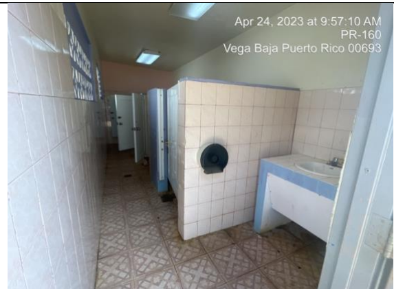
Baño de hembras – 5 inodoros dañados, 1 lavamanos dañado, 1 operador de ventana, lavado de presión, primer y pintura
