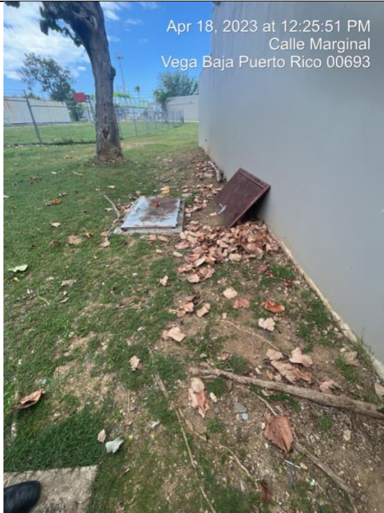
Trampa de grasa – mantenimiento
