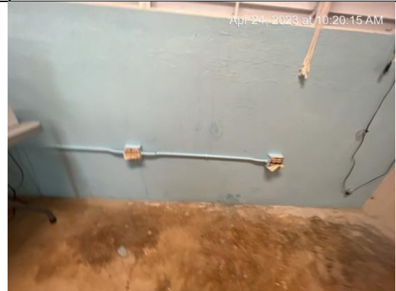
Salón Educación Especial 2 – 1 aire acondicionado, 4 receptáculos dañados
