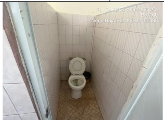
Baño de varones – 4 inodoros dañados, 1 una puerta sin cerradura
