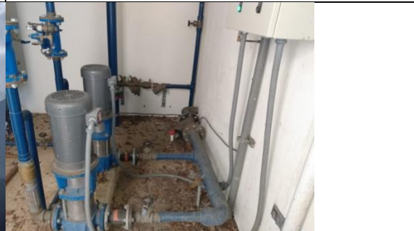
Cuarto de Bombeo – Mantenimiento
