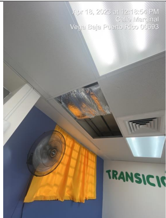
Salón C102 – Aire, filtración y acústico
