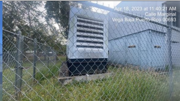
Subestación y generador – Mantenimiento
