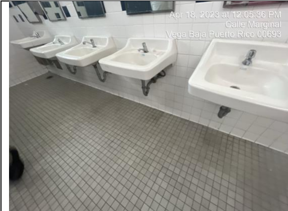
Baño de varones tercer nivel – llaves de lavamanos sueltas
