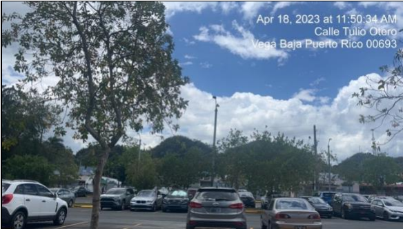
Luminaria estacionamiento – alumbrado dañado
