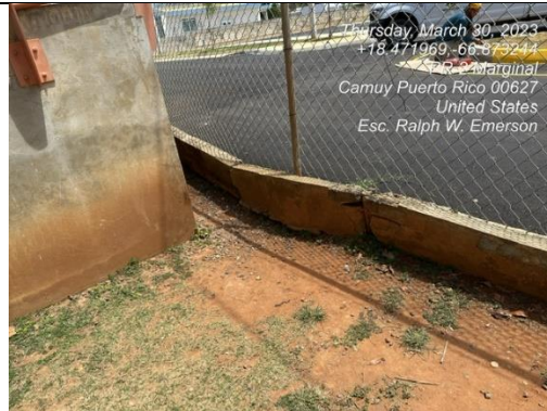
Ilustración 20. Base en concreto rota (de la verja de alambre eslabonado)
