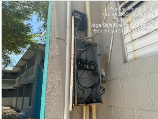
Ilustración 21. Trabajos electricidad expuesta
