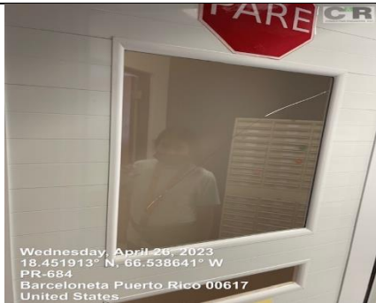
Ilustración 15. Reparación Puerta Cristal roto
