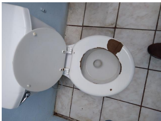
Foto 4. Reemplazar tapa de inodoro.
