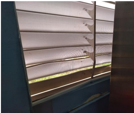
Foto 13. Reemplazar ventanas rotas.
