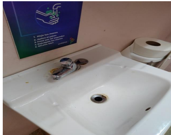
Foto 2. Reemplazar mezcladora lavamanos dañada.
