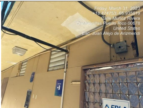
Ilustración 15. Ventanas para reparar
