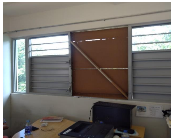
Foto 14. Reemplazar ventana rota.
