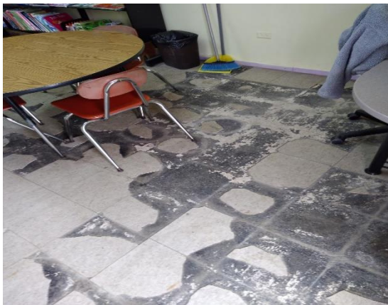
Foto 7. Reemplazar losa de vinil en piso.
