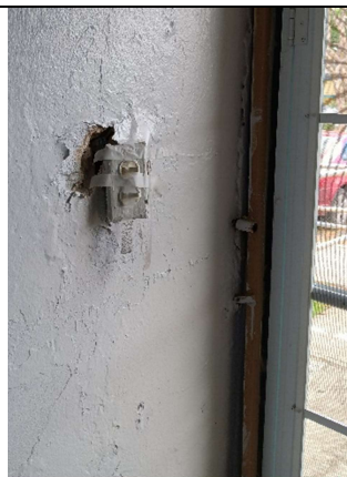
Interruptor en comedor escolar no se encuentra fijo al cemento, para nada seguro.
