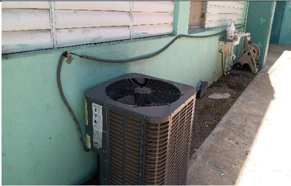
Continuación de la tubería anterior, cablería expuesta tubería plástica flexible nada segura al alcance de los estudiantes.
