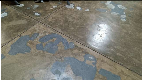
Área de piso con huecos para empañetar.
