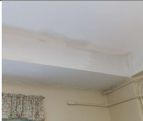
Filtración y humedad..
