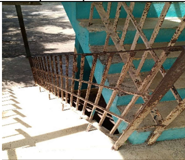
Reemplazar barandas en mal estado.
