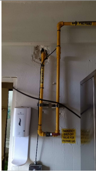
Empanetar hueco en area de tubería de gas propano.
