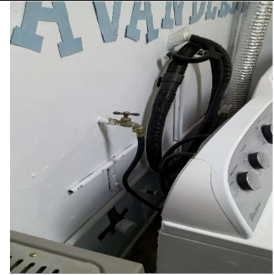
Proveer tapa a tubería expuesta que no se utiliza y sifón a la tubería descarga para eliminar el mal olor.
