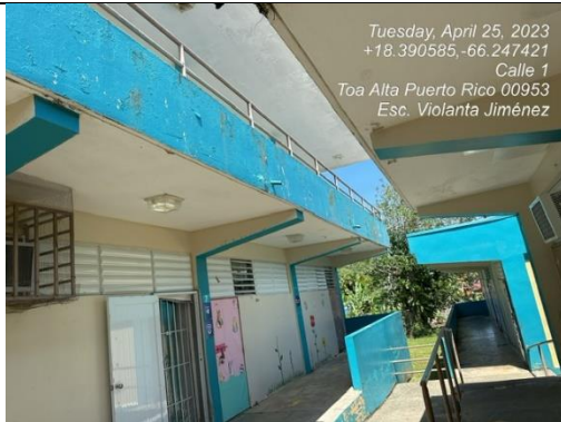
Ilustración 7. Condición de pintura
