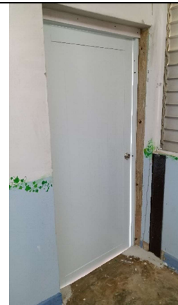
Remplazar puerta de aluminio en área de exterior por una de acero que provea seguridad a la escuela.
