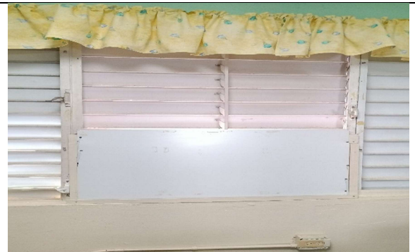
Reemplazar ventana no funciona porque se eliminó el aire y no la reemplazaron.
