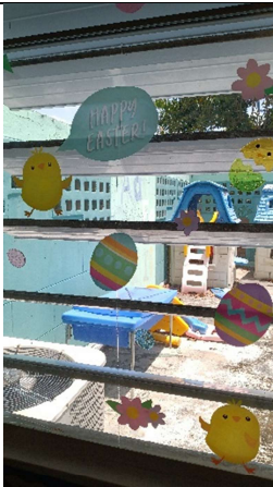
Cristal en ventana de seguridad estillado.
