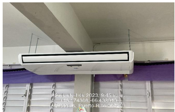
Ilustración 28. Mantenimiento de consolas de aire acondicionado.
