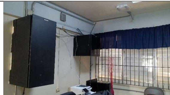
Salón con aire dañado y es necesario para el funcionamiento de los equipos electrónicos.
