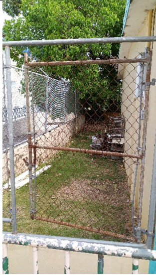
Porton para reparar.
