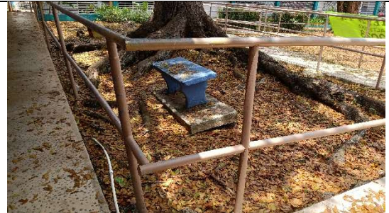
Barandas desalineadas, bancos virados y aceras poco segura para dar acceso a personas con silla de rueda. Las pendientes de las rampas no cumplen.
