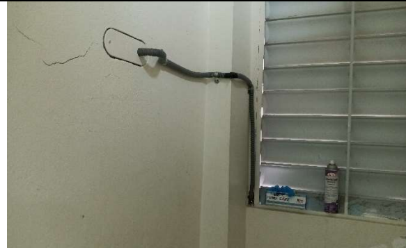
Tubería eléctrica mal ubicada y con tubería plástica flexible, proveer tubo rígido para protección y mejor ubicación. utilizar.
