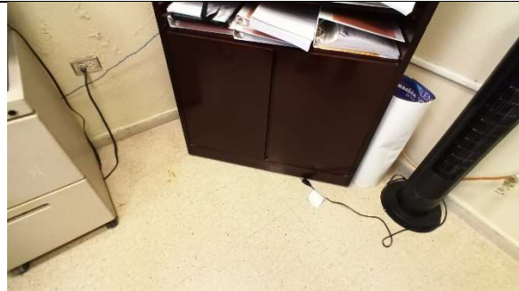
Área donde se filtra en la oficina.
