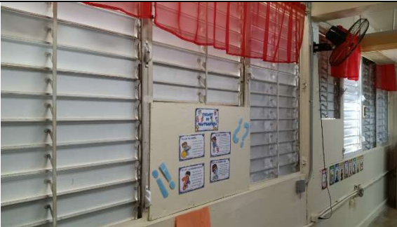
Operadores de ventanas dañados.
