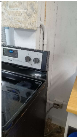
Proveer un receptáculo 220v adicional para que todas las maquinas tenga el suyo y no tener que estar con el quita y pon.
