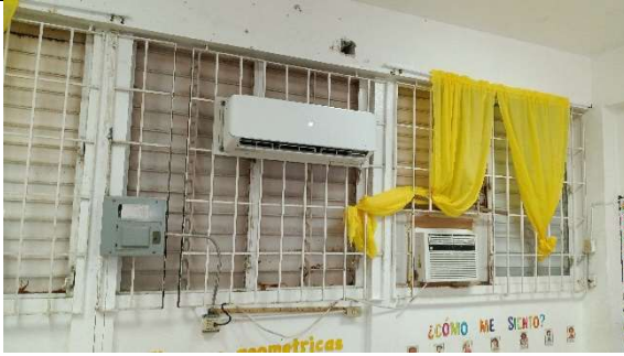
Panel eléctrico sostenido de la verja con conexiones de flexible plástica a la altura de las mesas de los estudiantes..
