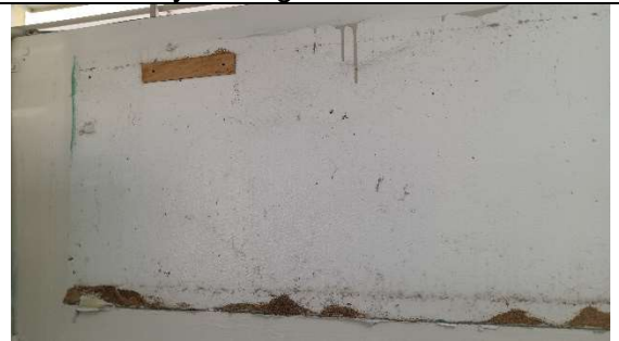
Reemplazar pizarra en mal estado.
