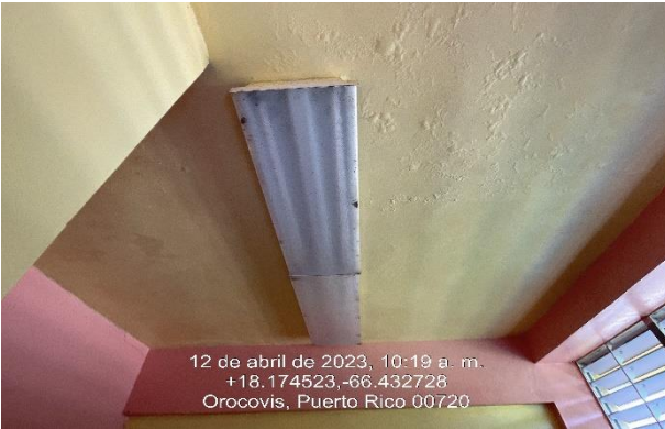
Ilustración 41. Reemplazo de luminarias.
