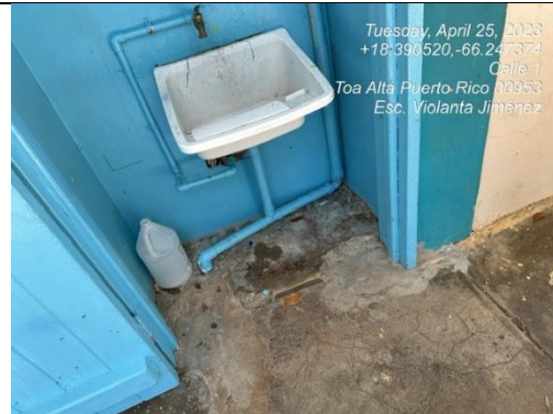
Ilustración 22. Filtración en sifón de lavamanos
