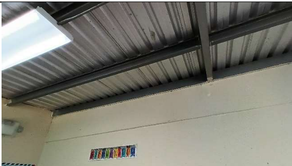
Techo en metal con filtración por todas las áreas.
