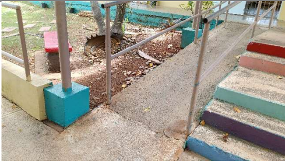
Rampa que no cumple con las pendientes, resbala cuando llueve y ya han ocurrido accidentes en el área.
