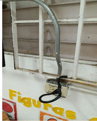
Conexión mal construida y peligrosa.
