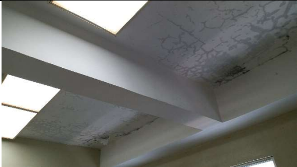
Humedad y filtración en plafones.
