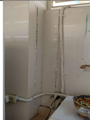
Tubería plástica expuesta no segura, reemplazar por tubería rígida.
