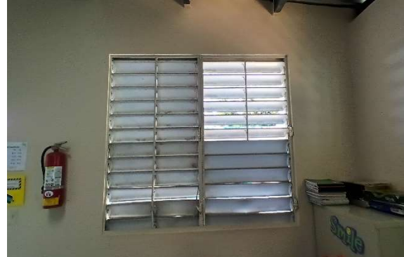
Ventanas para remplazar.
