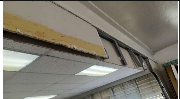
Pared que no se ha removido completamente con riesgo a que se le caiga un metal a cualquier usuario del salón.
