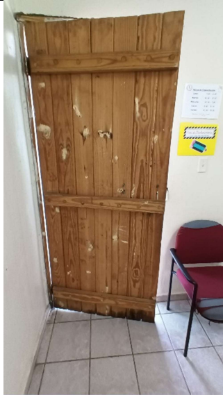
Reemplazar puerta dañada.
