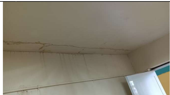
Filtración en cuarto de almacén en todo el techo. .
