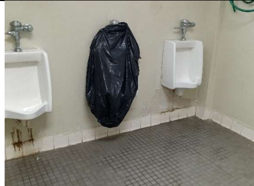
Urinales dañados con liqueos
