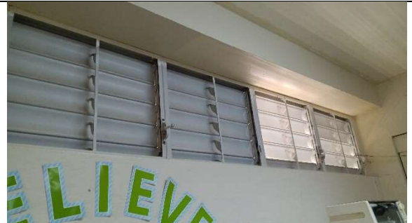
Reemplazar operadores de ventana dañados
