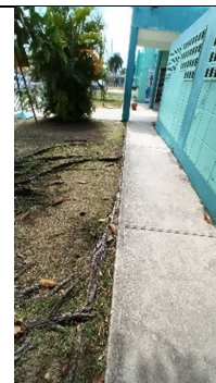
Falta relleno o instalar baranda para proteger de caídas a los peatones.
