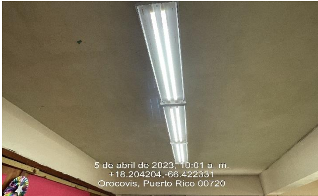
Ilustración 29: Reemplazo de luminarias.
