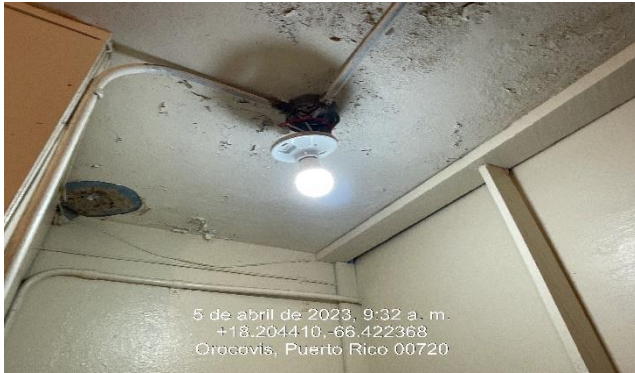
Ilustración 23: Corrección de instalación de roseta y bombilla.
