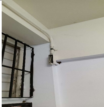
Proveer tapas a conduleto eléctrico y tapan hueco alrededor de la tubería
