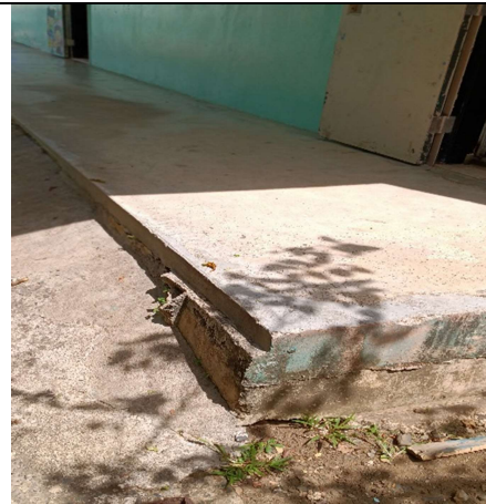
Acera necesita baranda para proteger de caídas a los usuarios.
