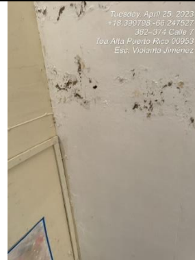
Ilustración 6. Condición de pintura
