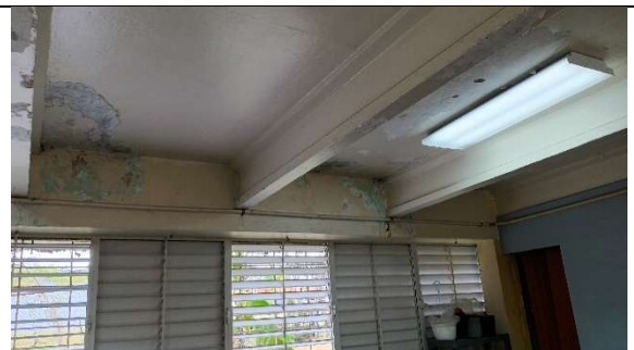
Presencia de filtración de techo.
