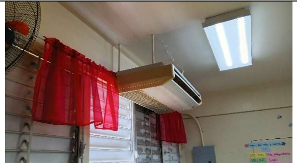
Remover A/C dañado que no removieron los que instalaron el que existe actualmente.
