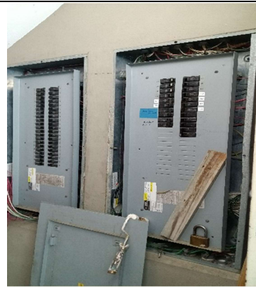
Paneles eléctricos en área de covacha, sin tapas.
