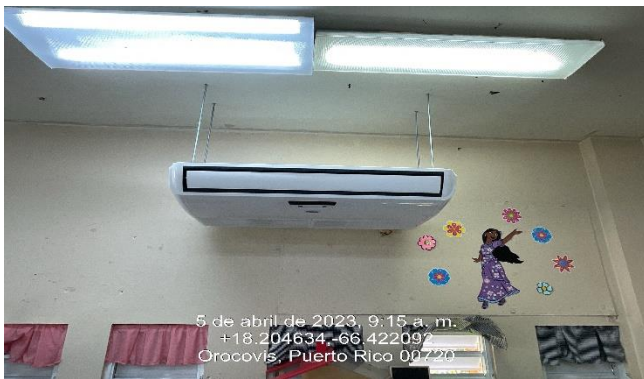
Ilustración 9: Mantenimiento de consolas de aire acondicionado.
