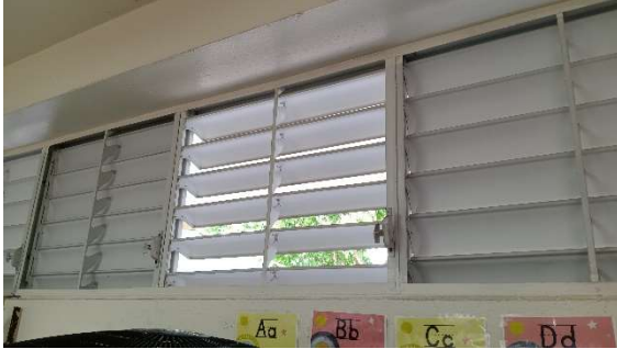
Operadores de ventana dañados.
