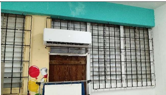
Reemplazar ventana rota, mantenimiento de aire y madera de marco de aire tiene comején
