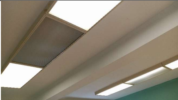
Remplazar iluminaria dañada.
