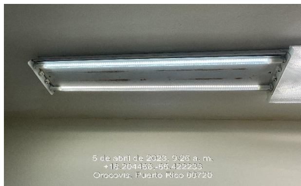
Ilustración 22: Reemplazo de luminarias.
