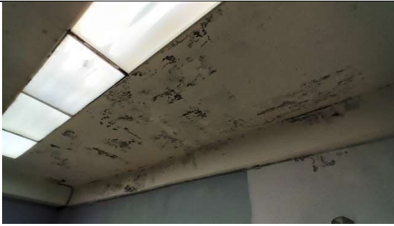
Salón con filtración extrema que el agua cuando llueve baja por pared como una cascada.
