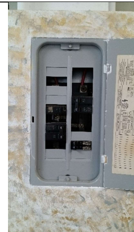
Tapa de panel eléctrico en el salón de autismo poco segura con huecos que facilitan la entrada de un dedo y que haya un accidente y no tienen candado de acceso.
