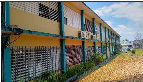
Pintura de exterior y area donde llueve y tienen problemas de filtracion en los salon a través del piso y la jardinera.
