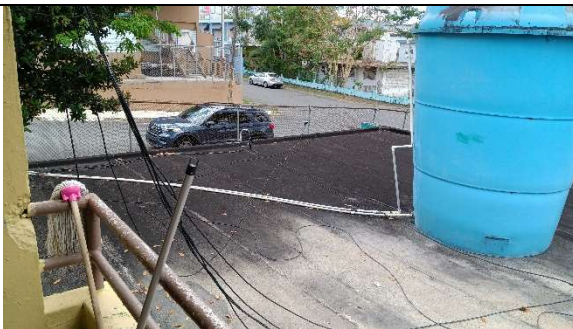
Sistema de cisterna por gravedad que no funciona porque la mayoría de los inodoros son sin tanque y no se pueden utilizar los baños, proveer un sistema de bombeo.
