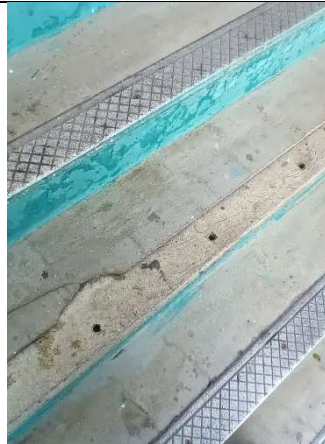
Escalones sin bullnozes.
