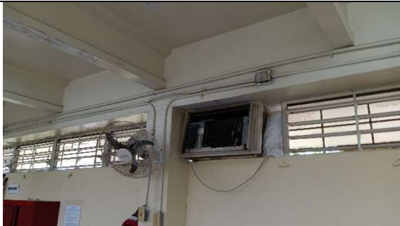
A/C de ventana dañado para removerse.
