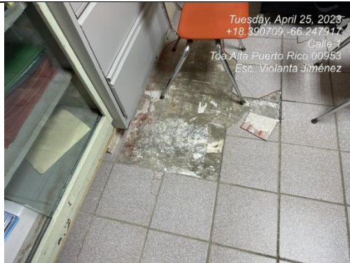
Ilustración 21. Losas en piso dañadas
