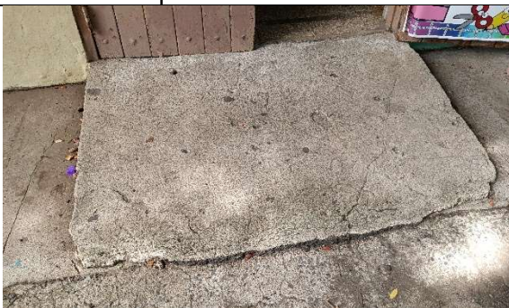
Rampas de acceso a salones mal construidas.
