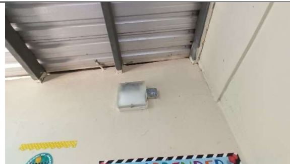
Filtración de agua afecta los equipos en las paredes.
