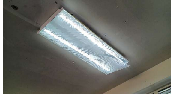
Lampara con protección rota y le faltan tubos para mejorar la iluminación.
