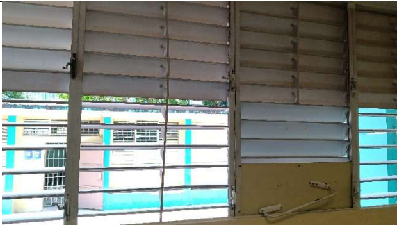
Ventanas para remplazar, soporte den el centro esta pandeado.
