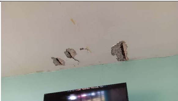
Empañetar área de plafón donde se desprende el cemento por oxidación de la varilla estructural.
