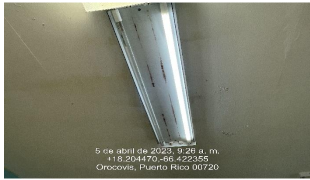
Ilustración 20: Reemplazo de luminarias.
