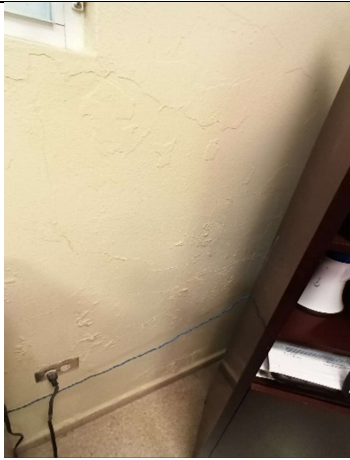
Filtración en oficina de director extrema.
