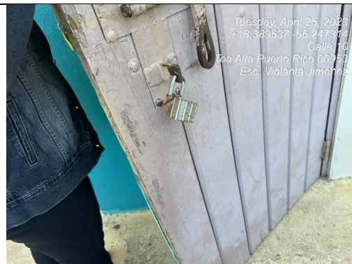
Ilustración 10. Puertas en madera dañadas
