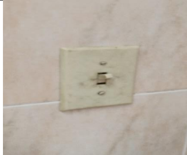
Interruptor electrico dañado.
