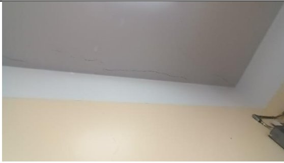
Grietas en el techo para reparar.
