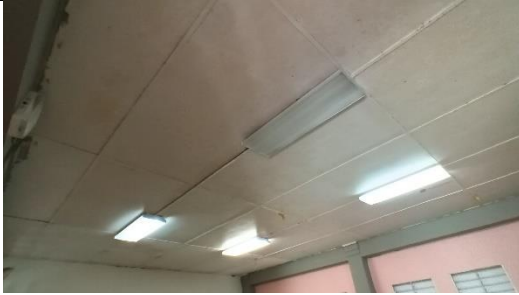
Remplazar por plafón acústico.
