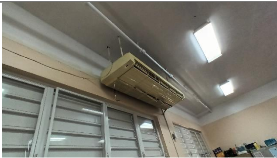
A/C dañado que no fue removido cuando instalaron los aires de ventana, esto pasa en la mayoría de los salones. Lo que no funcionan permanece en el salón con lo nuevo.
