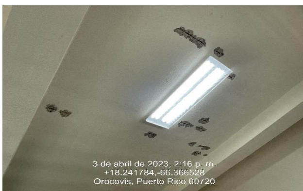
Ilustración 39: Techos con varillas expuestas.
