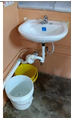
Línea de para la fuente mal conectada a la llave que filtra cuando toda el área o hay movimiento.
