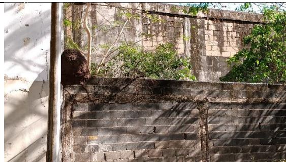
Presencia de comején en el área de patio.
