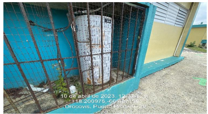
Ilustración 28. Calentador de agua se apaga.
