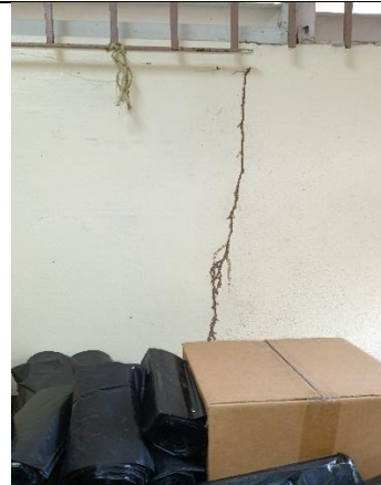
Presencia de comején en comedor.
