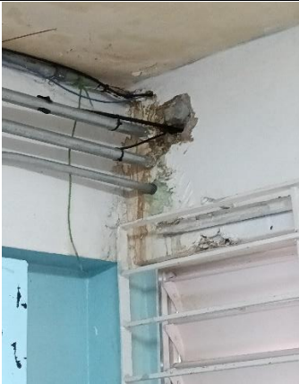
Pared con filtración y en área de tubería para corregir.
