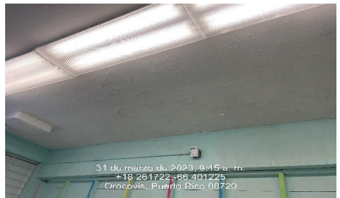
Ilustración 26: Filtración y humedad en techos.
