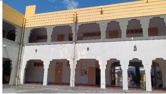
Tubería de drenaje de techo para ser reparada.
