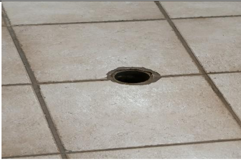
Parrilla para drenaje de piso en los baños.
