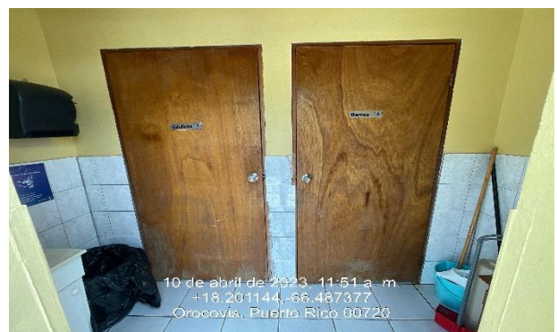
Ilustración 10. Reemplazo de puertas de particiones de baños por puertas de metal y su cerradura.
