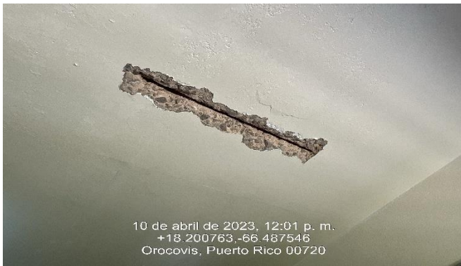
Ilustración 13. Varillas expuestas en techo de salón de clases.
