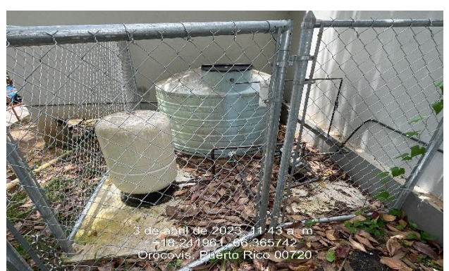
Ilustración 2: Cisterna y bomba dañada.
