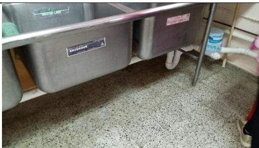
Lugar donde hay filtraciones desde el almacén al comedor y se inunda toda el area.
