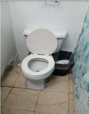
Remplazar inodoro dañado.
