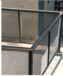
Baranda para remplazar ejemplo de parilla despegada en segundo nivel del descanso de escalera.
