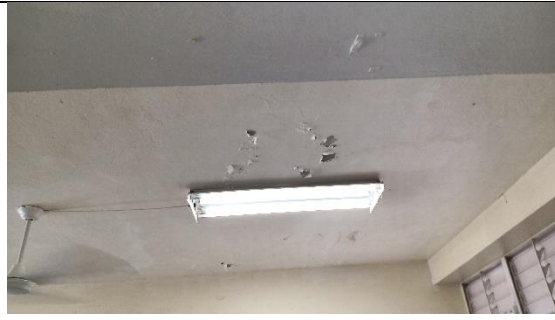
Filtración de techo.
