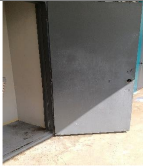
Remplazar puerta de metal.
