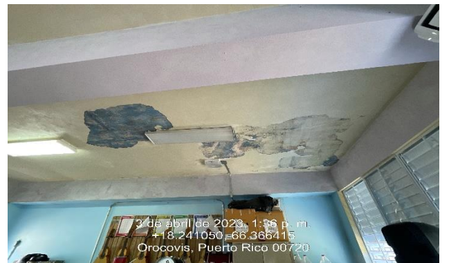
Ilustración 32: Corregir empañetado de techos salón de música.
