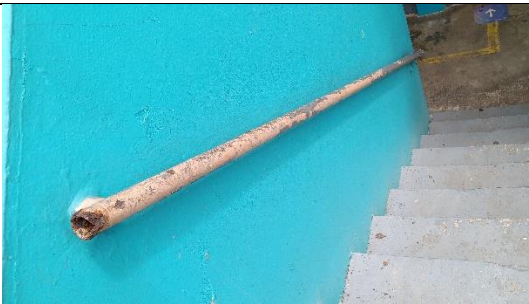
Pasamanos en mal estado a ser remplazados.
