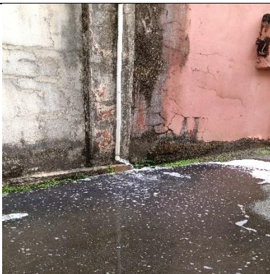
Aguas usadas del vecino descargan en el estacionamiento del plantel.
