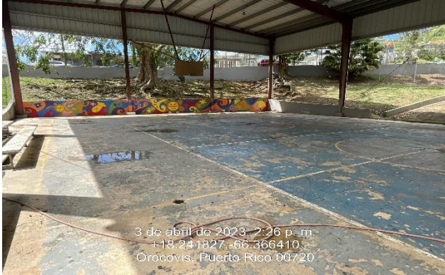
Ilustración 41: Cancha cerrada por problemas con columnas de acero y perlins.
