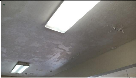
Filtración de techo.
