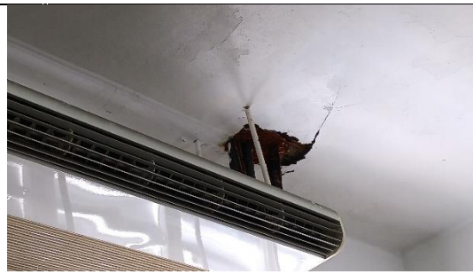
Area de filtración extrema en todos los casos donde se instalaron A/C.
