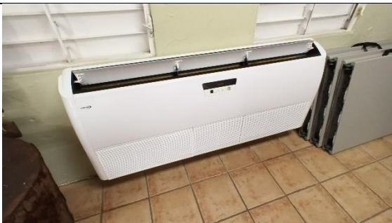
Mantenimiento de A/C.
