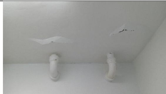
Área de inodoro con filtración por las tuberías y empañetado para corregir.
