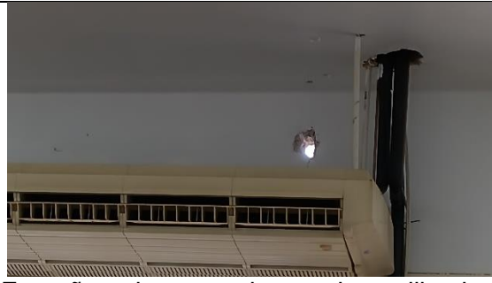
Empañetar hueco en la pared no utilizado para la tubería de A/C. filtración e empañetar hueco donde se colocaron los tubos.
