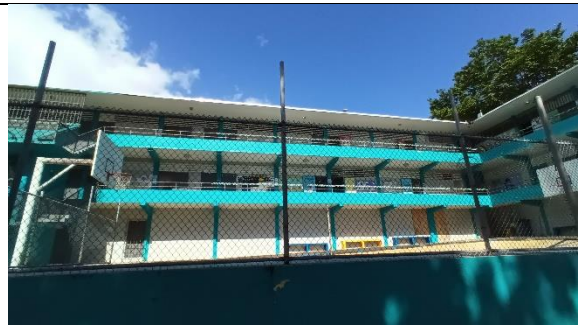
Pintura en patio interior de la escuela.
