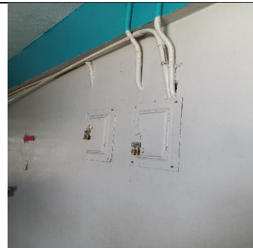
Paneles eléctricos se encuentran en el pasillo al alcance de los niños es necesario una tapa de acceso segura.
