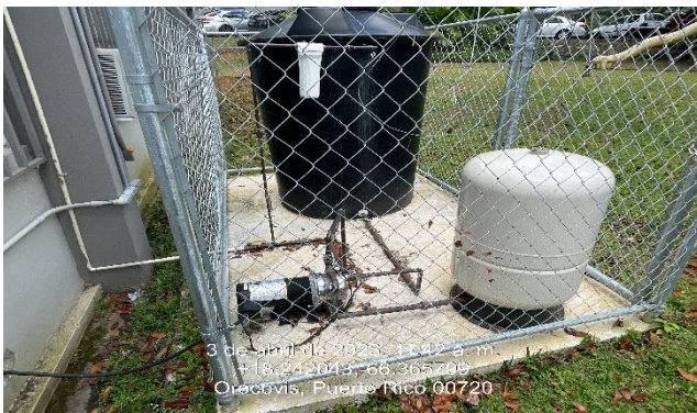
Ilustración 1: Bombas de cisterna dañada.
