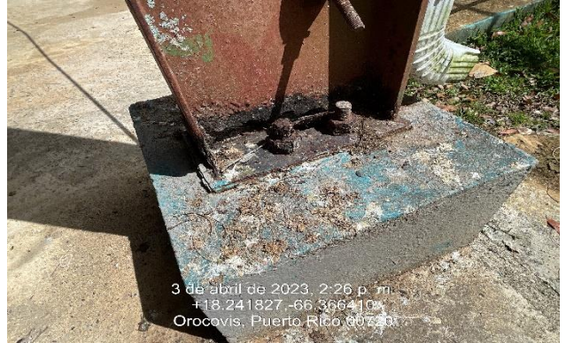
Ilustración 42: Cancha cerrada por problemas con columnas de acero y perlins.
