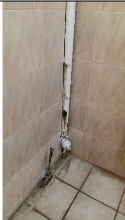
Tubería de desagüe en baño en mal estado para remplazar.
