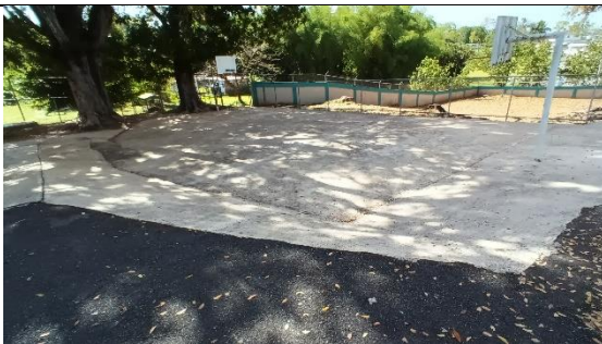
Baranda para instalar en el borde del talud de cemento para seguridad de los niños.
