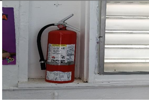
Extintor vencido desde el 2018.
