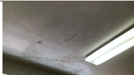
Presencia de filtración en varios lugares.
