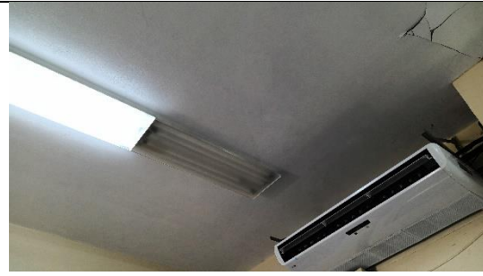
Remplazar lampara dañada.
