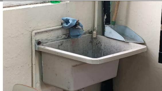
Llave de pileta dañada.
