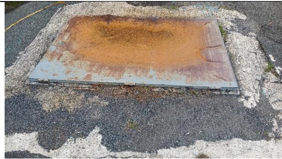
Remplazar puerta de acceso a trampa de grasa que sea construida heavy traffic ya que se encuentra en el área de estacionamiento
