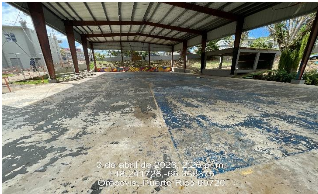
Ilustración 43: Cancha cerrada por problemas con columnas de acero y perlins.
