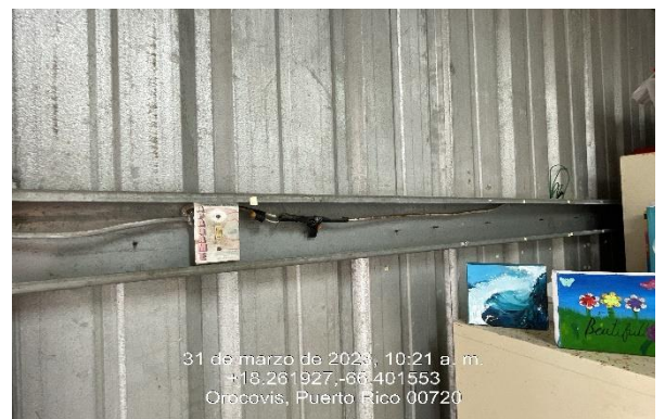
Ilustración 20: Cablería eléctrica expuesta.
