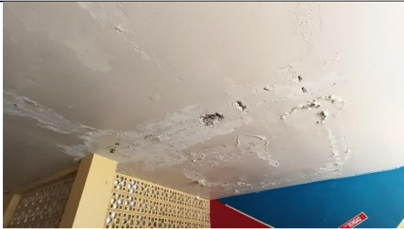
Empañetar área de pasillo en mal estado.
