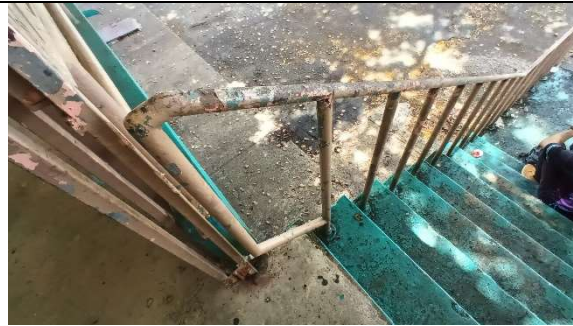
Remplazar barandas y pasamanos en mal estado.
