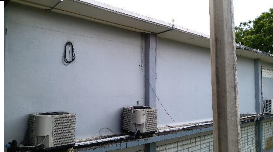
Área de ventanas eliminadas, ahora son salones de clase y no tienen la ventilación adecuada, ya tienen una orden para instalarlas, pero el trabajo no se ha realizado al momento de la visita. 25 ventanas
