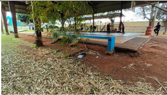
Area de la cancha socavada, con escalón que no es seguro para los que la utilizan.
