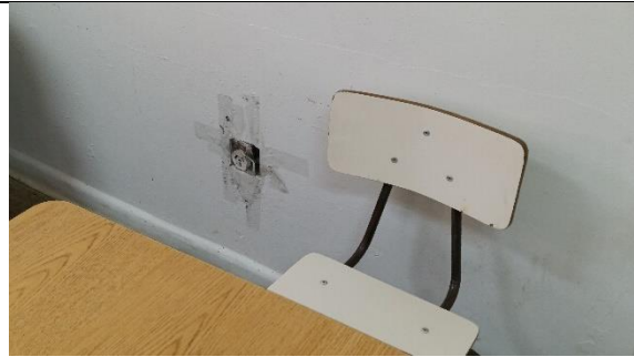
Receptaculo 22º sin tapa de protección.
