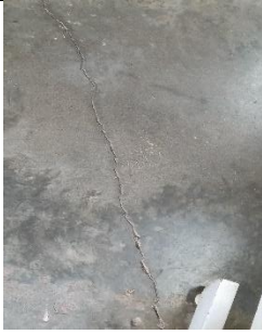
Corregir grieta en el piso.
