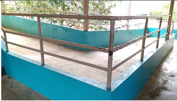
Reemplazar barandas corroídas.
