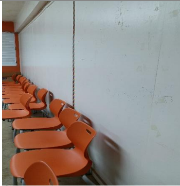
Pared divisora de salones en madera con polilla, remplazar por pared de Gypsum Board.
