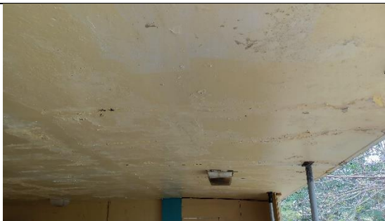
Pintura en pasillo de acceso a banos en mal estado.
