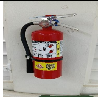
Mantenimiento de extintor caducado desde el 2019.
