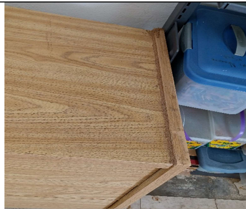
Evidencia de comején en uno de los salones.
