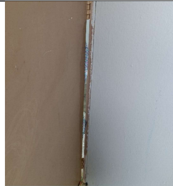
Goznes de puerta de tola para ser reemplazados por unos resistentes y corregir descuadre.
