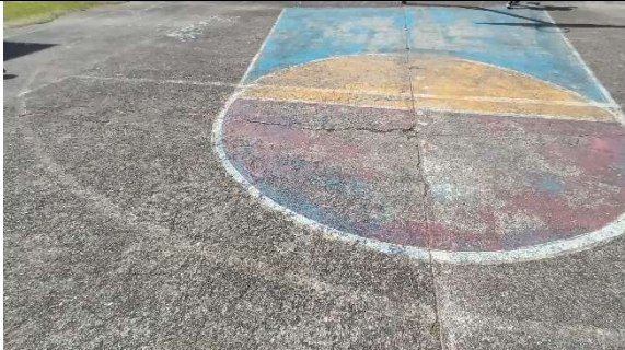
Cancha de exterior en mal estado.
