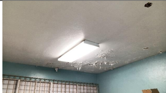
Filtración de techo.
