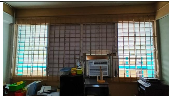
Screen para área de A/C y mantenimiento de aire.
