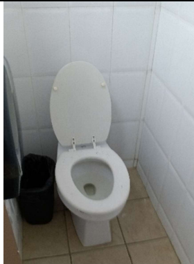
Cambiar tapa de inodoro dañada.
