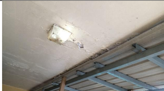
Area de techo galvanizado mal construido donde el agua cae toda en el pasillo y termina en los salones de clase.
