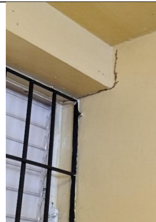
Comején en área de viga.
