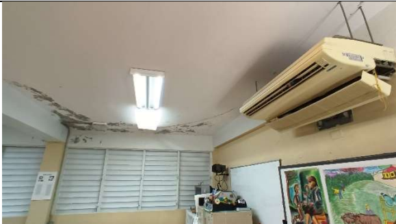
A/C para darle mantenimiento y humedad y filtración en el techo.
