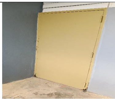
Puerta corroída por empozamiento de agua en los pasillos.
