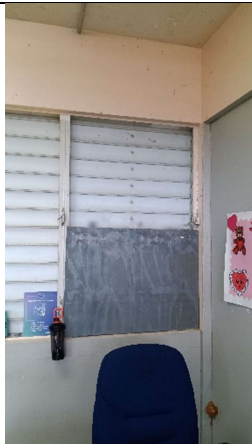
Reemplazar ventana con hueco de A/C dañado y removido.
