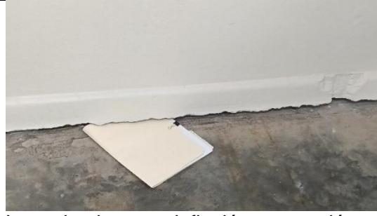
Losa de piso con deflexión separación entre parde y piso.
