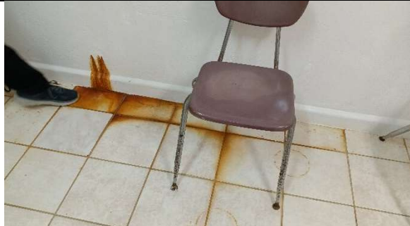
Filtración a través de la pared quizás de una tubería que esta corroída.
