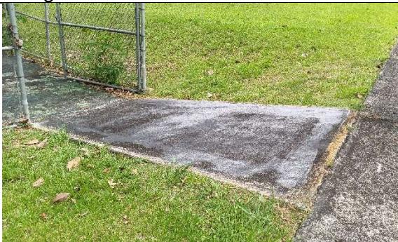
Rampa de acceso a cancha de Tennis con pendiente incorrecta.
