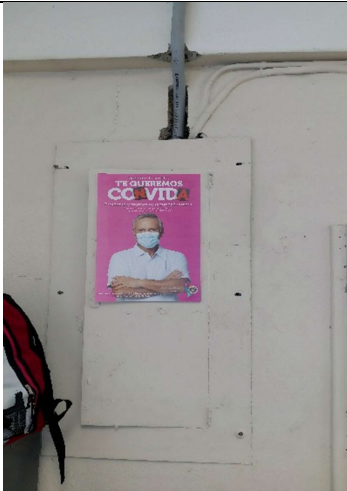
Panel perforado para instalar tuberías y no corrigieron el hueco que hicieron en la pared.
