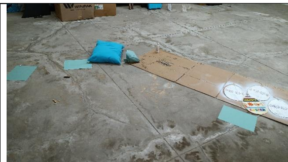
Salón no se puede utilizar por que se inunda cuando llueve, agua cae en el pasillo y penetra por la puerta.
