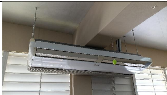
Mantenimiento a A/C de 18000 BTU.
