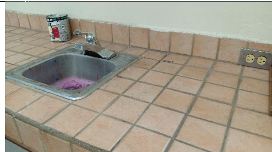
Cambiar fregadero y mezcladora. Receptáculo regular cambiar por ground fault.
