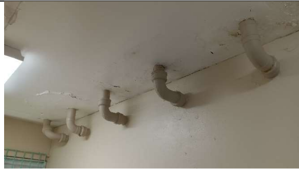
Tubería de inodoros con liqueo cuando se utilizan. La tubería expuesta se ve corroída necesita remplazarse.
