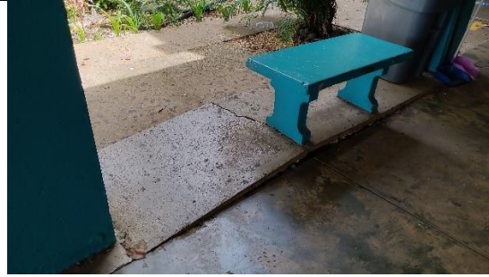
Acera levantada en área de banco.
