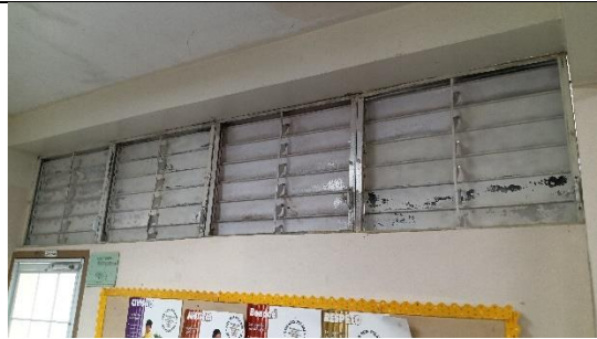
Screens de ventana para área con A/C.
