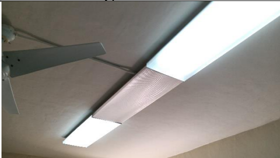
Remplazar lampara dañada.
