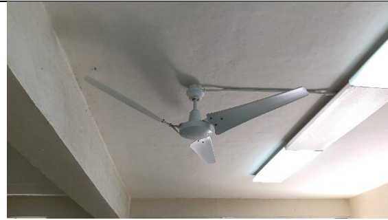
Abanico de techo dañado.
