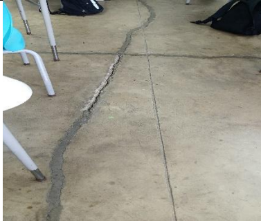
Reparar grieta en el piso.
