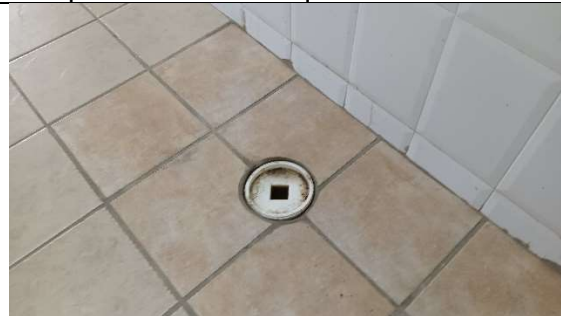
Remplazar tapa de registro por una flat para evitar accidentes.
