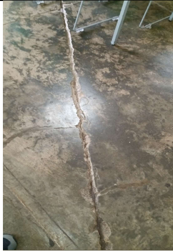
Grieta para corregir en el comedor escolar.
