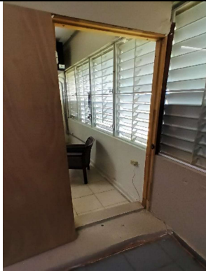
Remplazar puerta con polilla y comején y remover losa en el piso en entrada de puerta para evitar tropezones.
