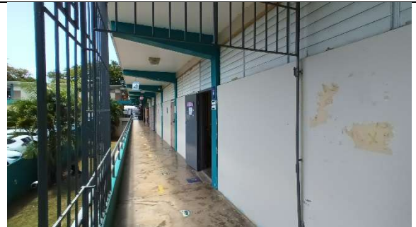
Instalar rejillas en los pasillos las que habían antes se cayeron de la corrosión que tenían.
