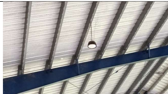
Reemplazar foco de cancha dañado.
