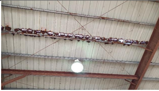
Techo de cancha en mal estado, con planchas corroídas.
