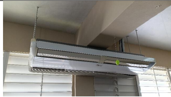
Mantenimiento a A/C de 18000 BTU.
