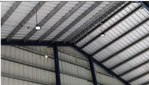
El techo de la cancha tiene huecos por donde filtra cuando llueve y los purlins algunos se encuentran en mal estado.
