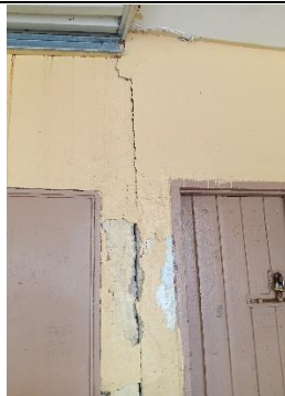
Grieta en escalera, fue clausurada el area porque en esta parte ocurrieron asentamientos.
