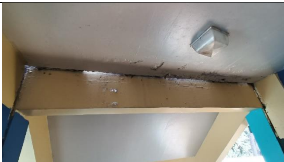
Junta de expansión térmica ya no existe y por el área cae una cascada de agua cuando llueve.
