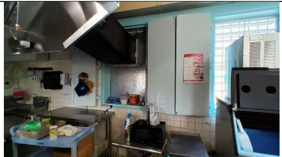
Colocar ventana debajo de extractor, es la única ventilación de la cocina.
