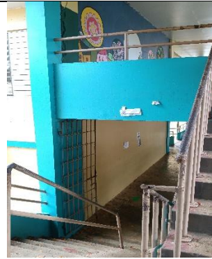
Reemplazar barandas y pasamanos corroídos.
