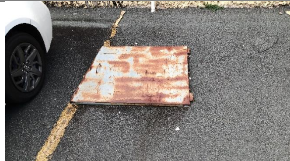
Proveer tapa para trampa de grasa que sea heavy ya que se encuentra en el estacionamiento de maestros.
