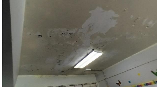
Area de filtracion.
