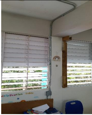
Tubería a relocalizar, obstruye los operadores de ventana.
