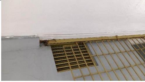
Reja suelta fijar para que funcione y no ocurra accidentes futuros
