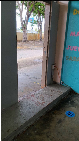
Eliminar muro de cemento en el piso en entrada de la puerta, fácil para proveer tropezones y accidentes.
