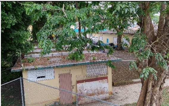
Area que no se utiliza por problemas estructurales.
