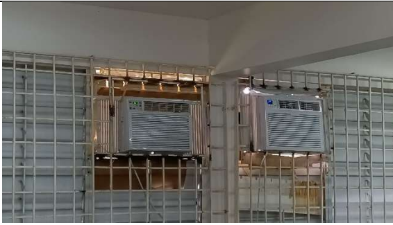
Faltan screens plásticos para poder abrir las ventanas, mantenimiento de los aires y cambiar marco de madera con polilla que sostiene los aires.
