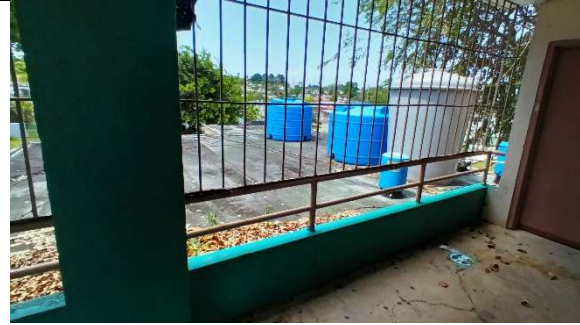
Cisterna que no funcionan.
