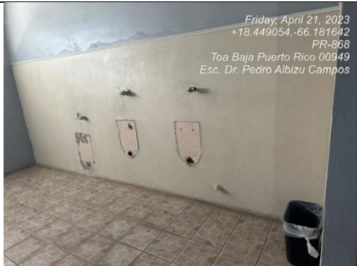
Ilustración 9. Urinales (tuberías tapadas)
