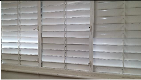
Reemplazar operadores de ventana dañados.
