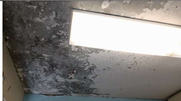
Humedad y filtración en plafón.
