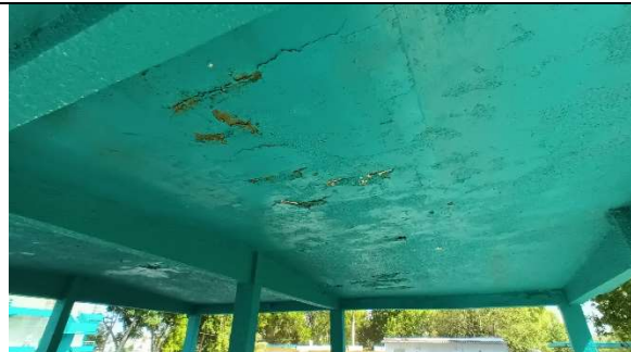
Gazebo con muchas áreas de cemento agrietado por la corrosión para reparar.
