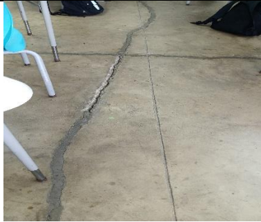
Reparar grieta en el piso.
