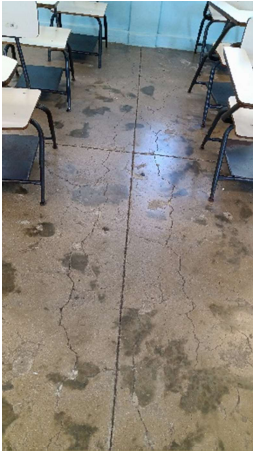
Salones con muchas grietas en todo el piso.
