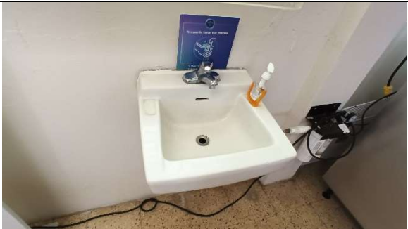
Cambiar fregadero dañado y mezcladora por uno ADA.
