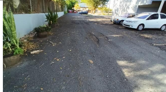
Area de estacionamiento a repararse.
