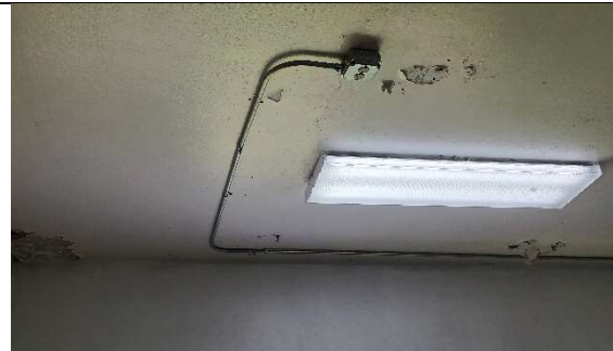
Humedad en salón de clase.
