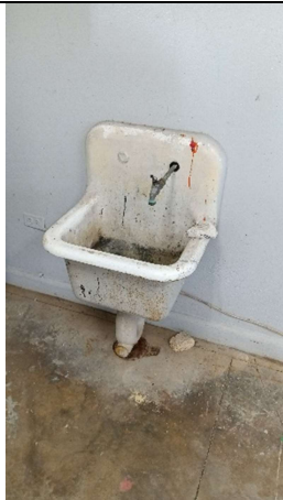
Remplazar topo en mal estado y pluma con liqueo.
