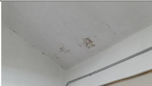
Filtración en techo de oficina de principal.
