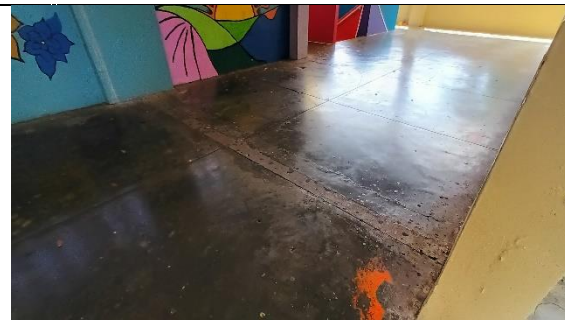
Junta de expansión en mal estado para reemplazar.
