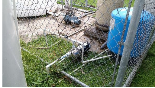
Sistema de cisterna para reparar, ninguna de las dos opciones que tienen funcionan.
