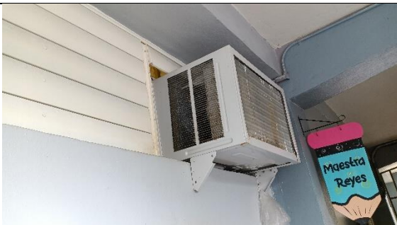
Remover A/C dañado.
