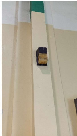
Foco de pared en cancha danados.
