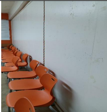
Pared divisora de salones en madera con polilla, reemplazar por pared de Gypsum Board.
