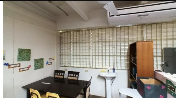
Faltan screens de plástico para evitar salida de A/C salón de autismo.
