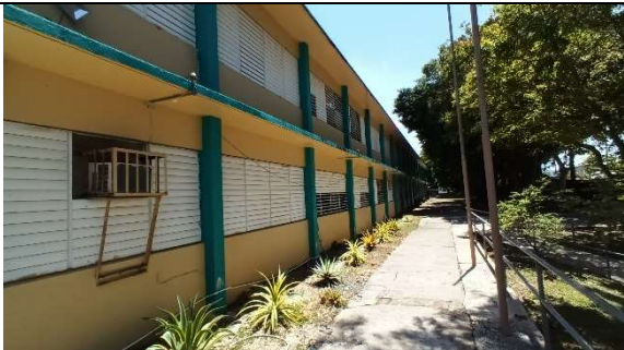
Área del edificio que se inunda y el agua percola dentro los salones por el piso.
