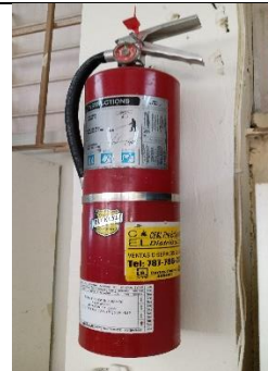
Extintores para mantenimiento, vencidos.
