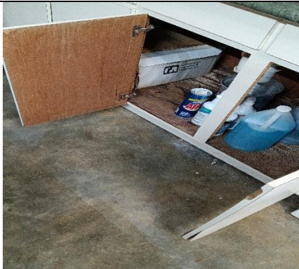
Gabinete con polilla en mal estado salón de autismo.
