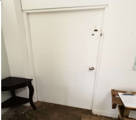
Reemplazar puerta de interior.
