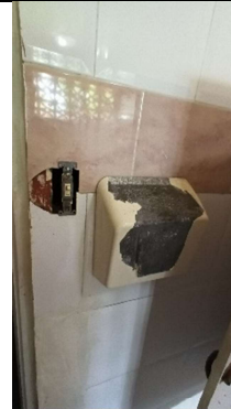
Remplazar interruptor sin tapa.
