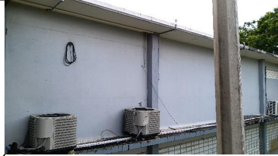
Área de ventanas eliminadas, ahora son salones de clase y no tienen la ventilación adecuada, ya tienen una orden para instalarlas, pero el trabajo no se ha realizado al momento de la visita. 25 ventanas
