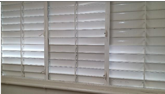
Remplazar operadores de ventana dañados.
