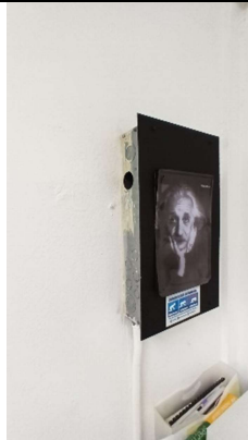
Panel eléctrico con hueco.
