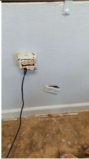
Receptaculos sin protección en mal estado.
