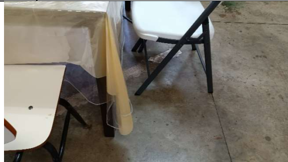
Hueco en el piso para ser tapado.
