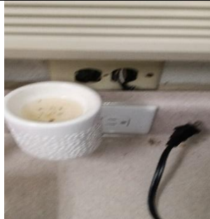
Cablería expuesta y receptáculo regular al lado del fregadero salón doméstico.
