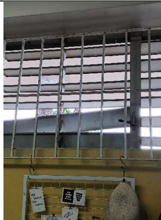
Remplazar ventana rota.
