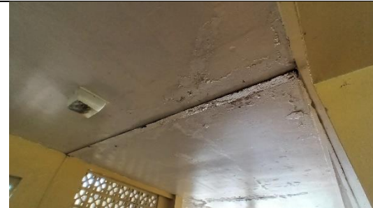
Reemplazar junta de expansión térmica.
