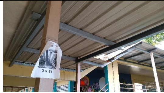
Pendiente de techo hacia los pasillos y planchas en mal posición que no ayuda a sacar el agua al patio.
