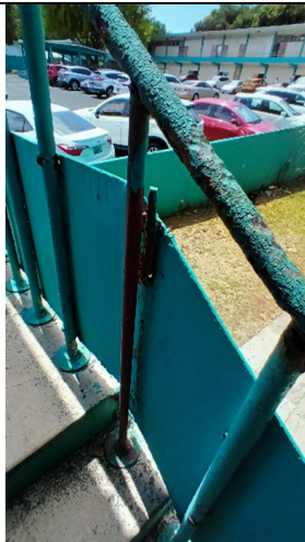
Barandas de escalera en mal estado, corroídas y se están zafando de su base.
