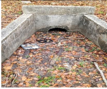
Area de tubería de estacionamiento tapada, causa inundación en el área.
