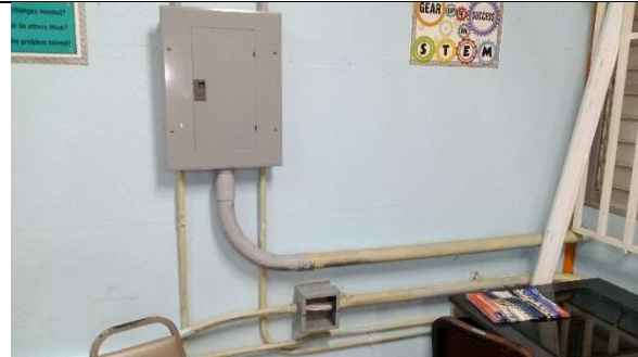
Cajas sin tapa y cablería expuesta.
