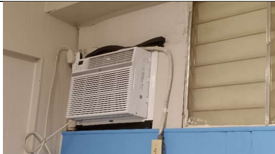
Mantenimiento de A/C.
