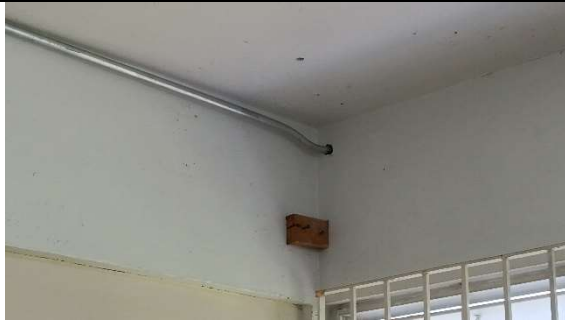
Filtración por tubería eléctrica.
