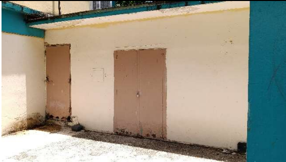
Puertas del cuarto eléctrico en mal estado.
