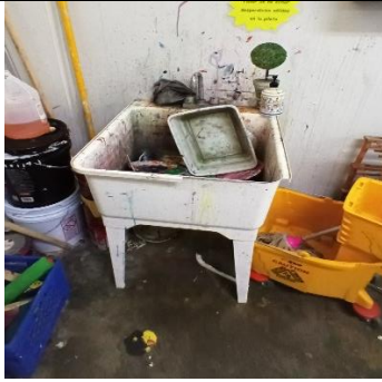
Pileta tapada para remplazar.
