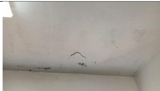
Filtracion y area para empanetar.
