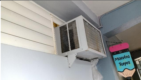
Remover A/C dañado.
