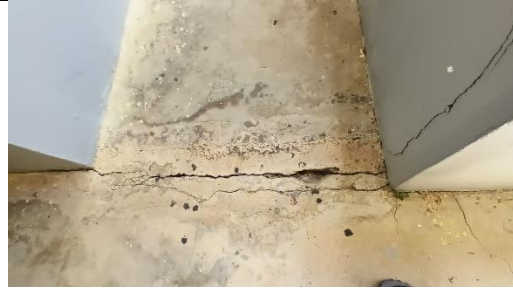
Grietas en áreas de junta de expansión.
