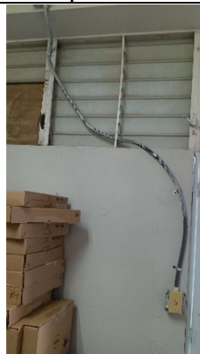
Tubería eléctrica mal ubicada y con tubería plástica flexible, proveer tubo rígido para protección y mejor ubicación ya que la ventana no se puede utilizar.
