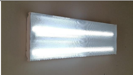
Lampara para 4 tubos y solo instalaron dos y el salón no está bien iluminado.
