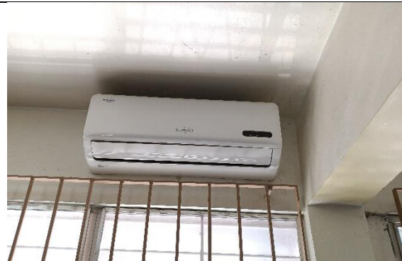
Mantenimiento de A/C.
