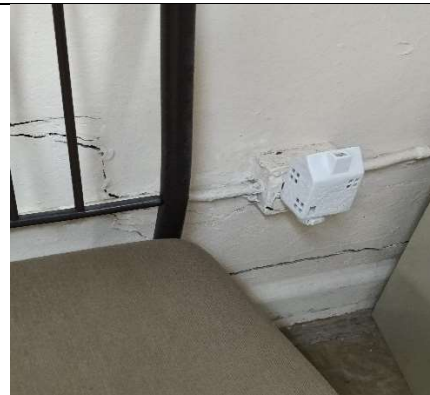
Área donde se desplazó el piso y la pared recomendaron que no se use esa área pero la están utilizando de oficina.
