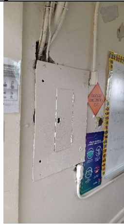
Hueco para empañetarse en entrada de tuberías a panel eléctrico.
