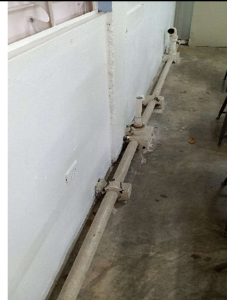
Tubería sanitaria dentro del salón para removerse, en esta situación es peligrosa para los estudiantes.
