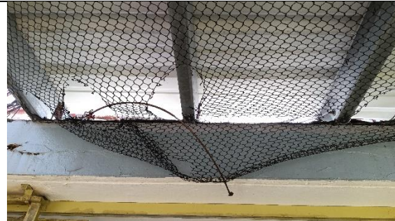
Mala repelente de aves dañada en cancha de baloncesto, techo de entrada y rampa para subir al segundo nivel.
