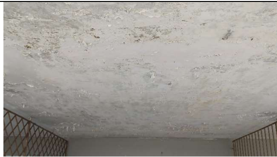
Area de plafon en pasillos para baño pintura en mal estado.
