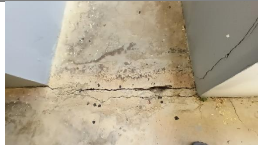
Grietas en áreas de junta de expansión.
