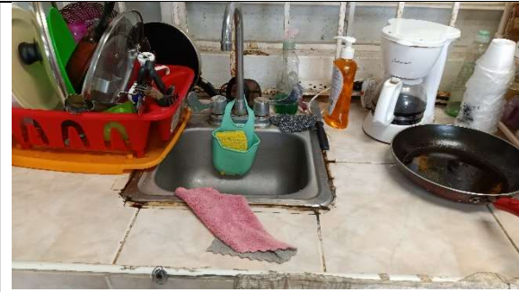
Cambiar fregadero y proveer receptáculos Ground fault cerca del área de agua.
