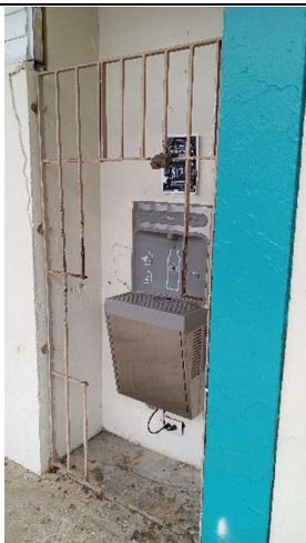
Reja en la fuente con figura de persona en vez de remover la reja, así está en todas partes que se encuentre una fuente.
