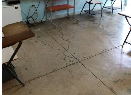
Salones con muchas grietas en todo el piso.
