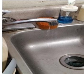
Mezcladora de fregadero para reemplazar con liqueo todo el tiempo.
