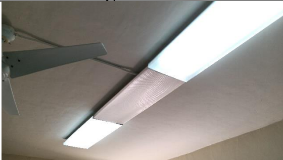
Reemplazar lampara dañada.
