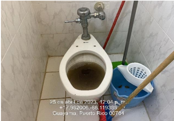
Ilustración 35. Reemplazo de inodoro de presión con válvula.
