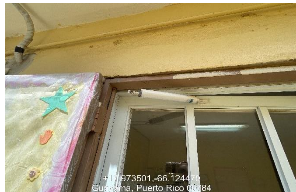
Ilustración 22. Botella hidráulica de puerta dañada.
