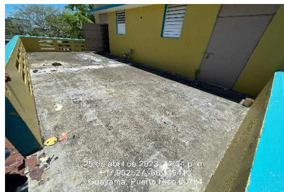
Ilustración 40. Techo del comedor con filtración.
