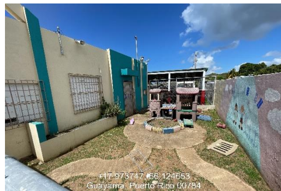
Ilustración 26. Realizar desagües en el patio debido a que se acumula agua.
