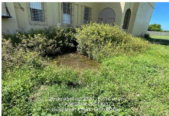
Ilustración 21. Agua acumulada por tubería rota.
