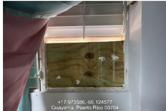
Ilustración 2423. Reemplazo de ventana "miami".
