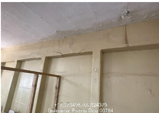
Ilustración 21. Viga en salón de clase con grietas.
