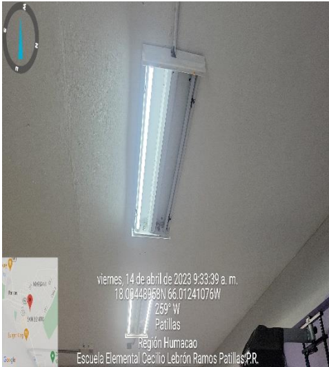
Falta de iluminación
