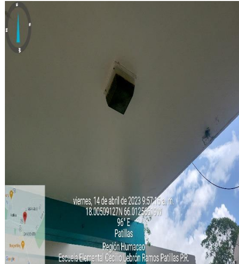
Falta de iluminación exterior
