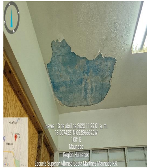
Caído de empañete y filtración
