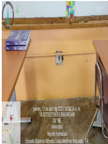
Ausencia de sistema eléctrico
