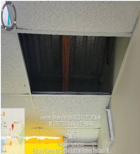
Falta de plafón
