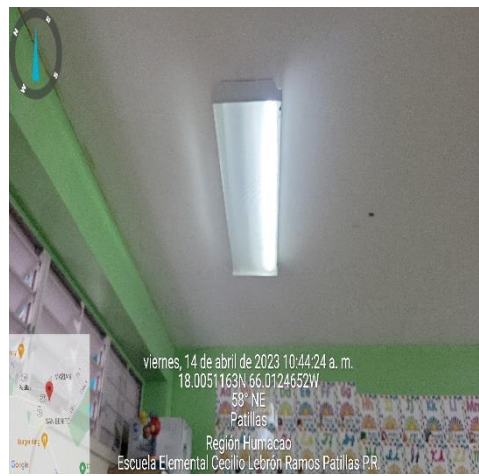
Falta de iluminación
