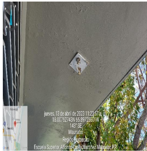
Falta de iluminación exterior
