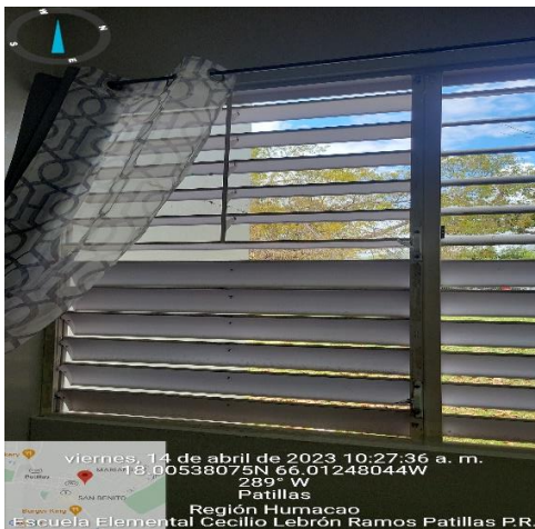
Ausencia de operadores y reparación de ventana
