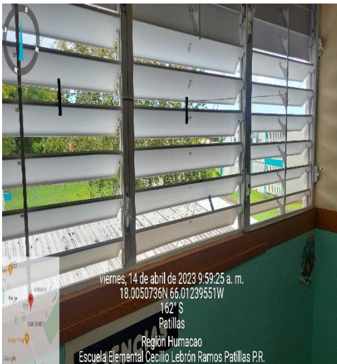
Ausencia de operadores
