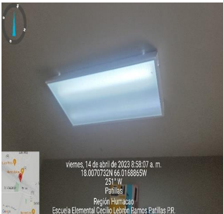
Falta de iluminación
