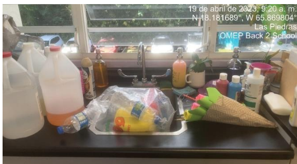
Ilustración 10. Los salones 39 y 62 los fregaderos tienen las tuberías tapadas.
