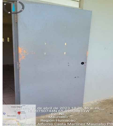
Puerta corroída para reemplazo
