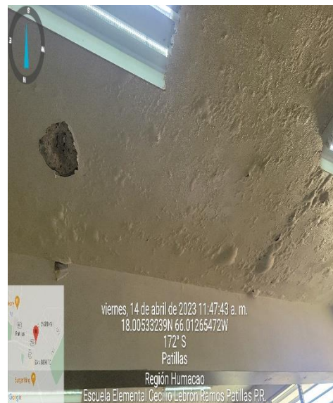
Filtración de techo y caída de empañete
