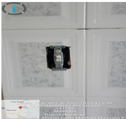
Falta de tapa en el interruptor
