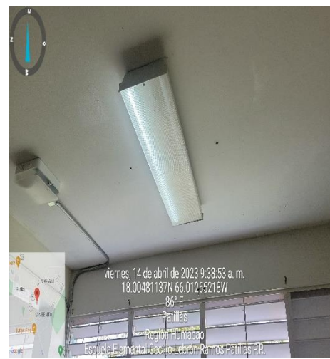
Falta de iluminación
