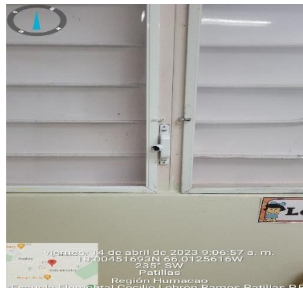
Ausencia de operadores
