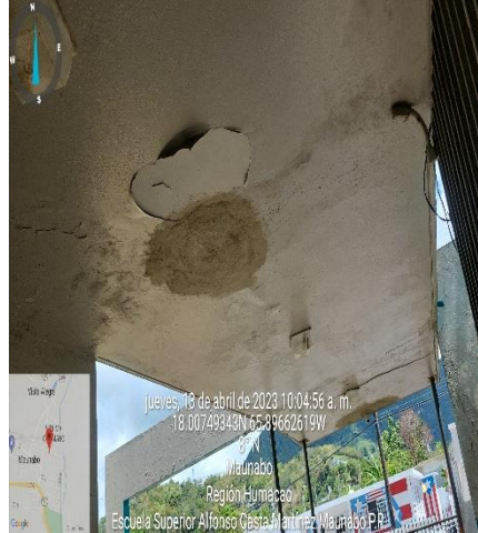
Filtración de techo y caída de empañete
