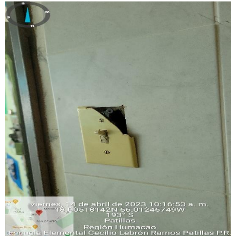
Falta de cubierta en el interruptor
