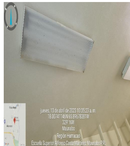
Falta de iluminación
