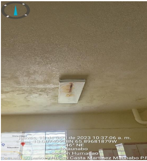
Falta de iluminación
