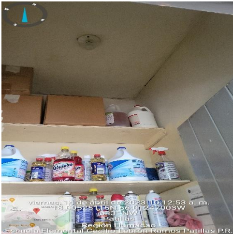
Falta de iluminación en la covacha
