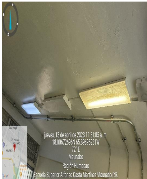
Falta de iluminación
