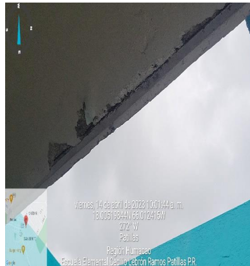
Caído de empañete exterior
