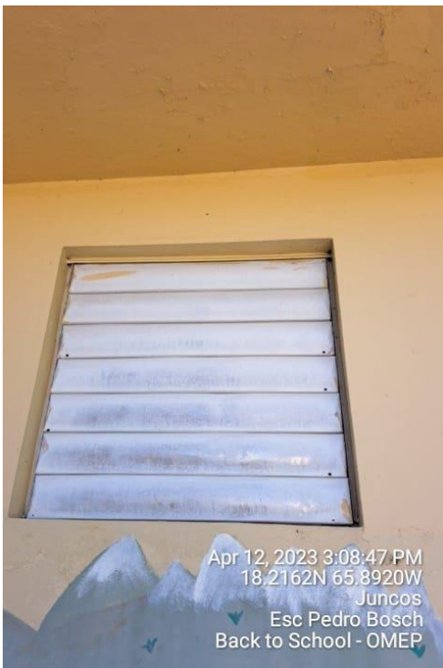
Ejemplo de ventana en Kinder con tornillos ya que no cerraban y para brindar seguridad al interior otras en el huracán María las arranco y solo las ubicaron en sitio con tornillos para tapar huecos
