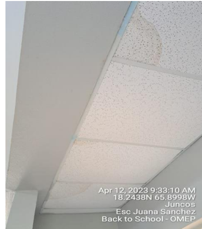
Filtración techo salón 10
