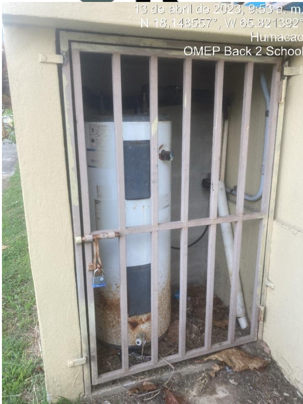
Instalación de un nuevo calentador.
