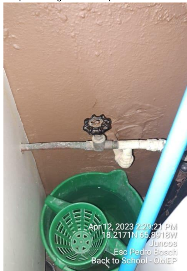
Liqueo de agua llave de paso
