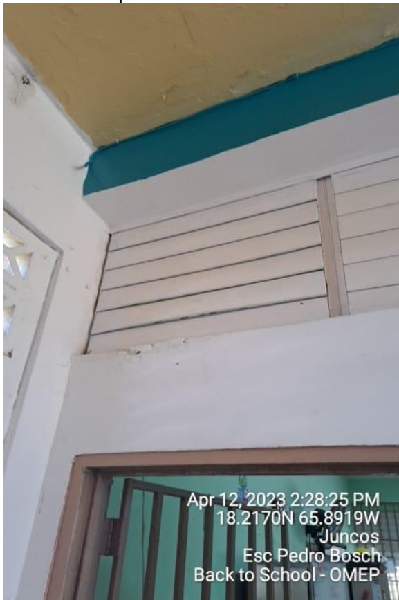
Ventanas que no abren
