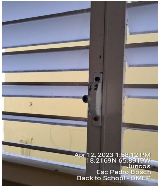
Ausencia de operadores
