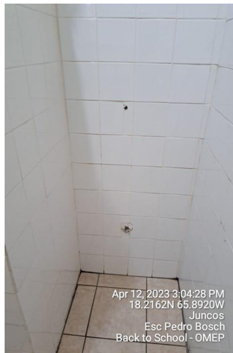
Falta urinal salón de kinder
