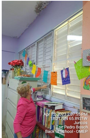
Ventanas que no abren
