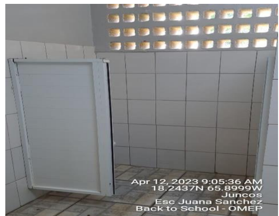
falta puerta cubículo del urinal
