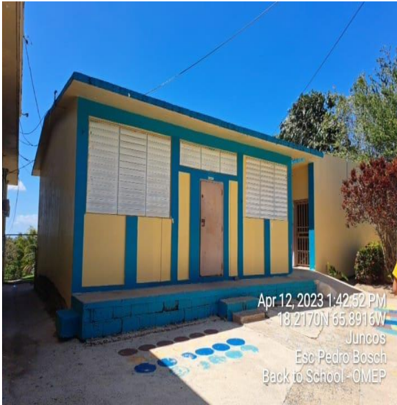
Ventanas que no abren
