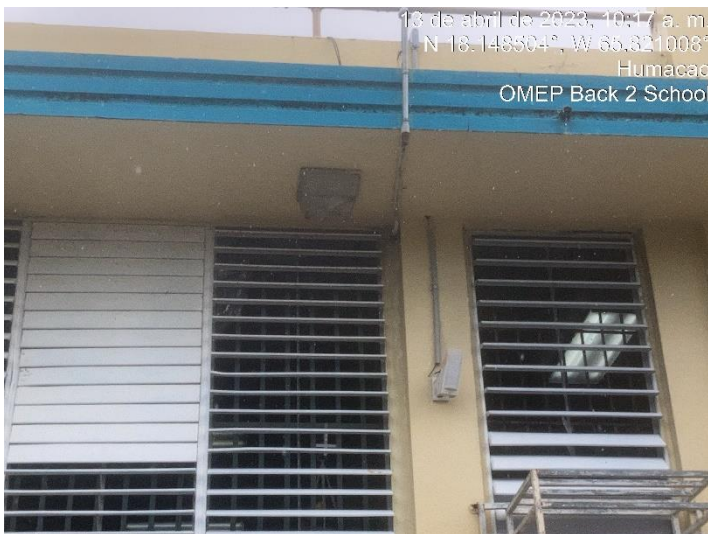
La escuela no cuenta con luminaria en la parte exterior del plantel escolar.
