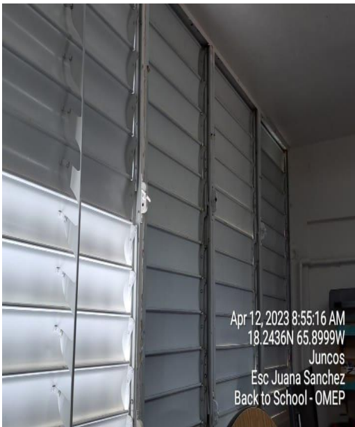
Ventanas que no abren
