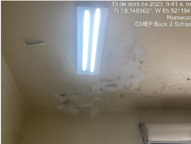
Filtración en el salón 8.
