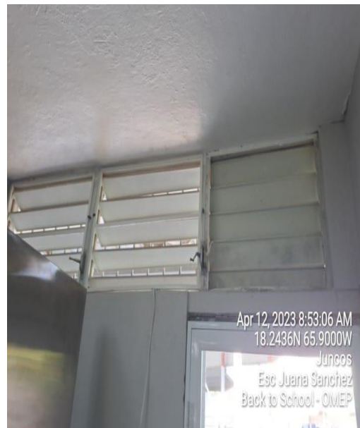
Ventanas que no abren
