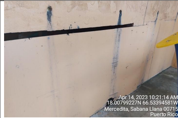
Madera divisora detrás de las escaleras y en salones llenos de comején.
