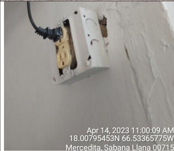
Cajas eléctricas sin tapas
