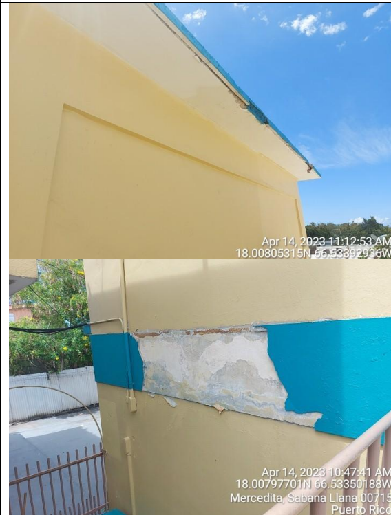
Desprendimiento de aleros y empañetado.
