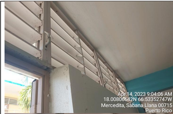
Grietas en el comedor.
