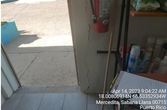
Grietas en el comedor.
