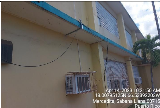
Cables de internet colgando.
