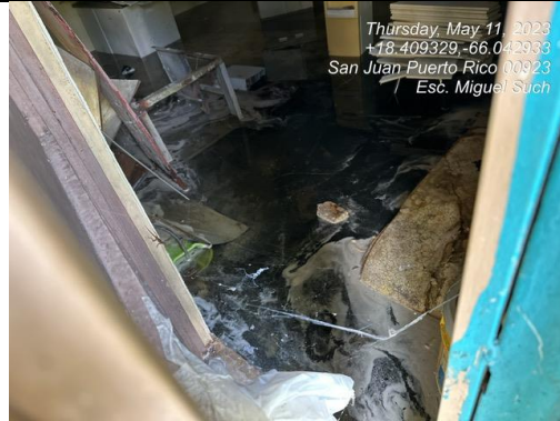
Ilustración 18. Salón sucio y con acumulación de agua
