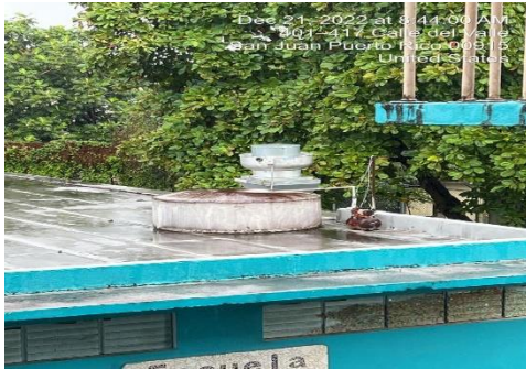
Ilustración 5. Reemplazar cisterna con motor del comedor
