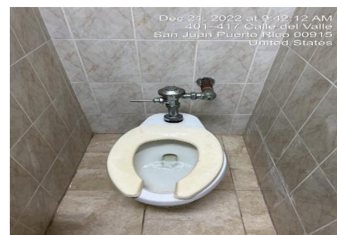
Ilustración 14. Reemplazar estos inodoros Top Spud por inodoros de tanques
