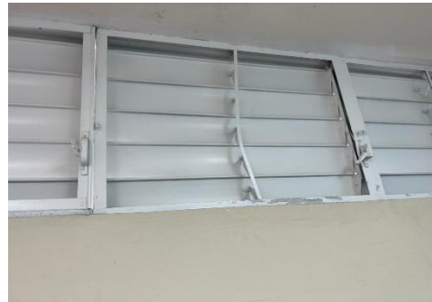
Ilustración 2. Reemplazar ventanas dañadas
