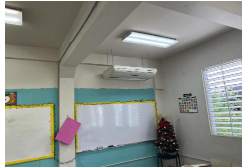
Ilustración 12. Mantenimiento de A/C
