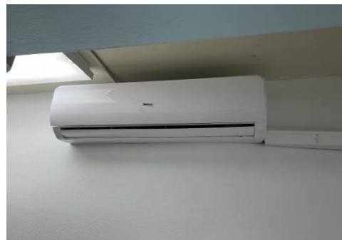
Ilustración 4. Mantenimiento de A/C
