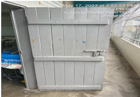
Ilustración 13. Reemplazar puertas de maderas por puertas de tolas
