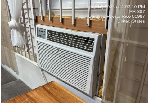
Ilustración 5. Mantenimientos de A/C
