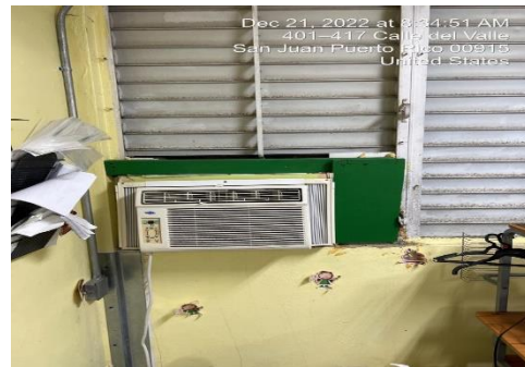
Ilustración 2. Mantenimiento de A/C
