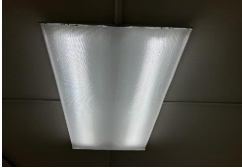
Ilustración 5. Reemplazar luces por luces LED
