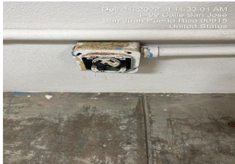
Ilustración 19. Reemplazar y revisar el alambrado 220 de todos los salones y sus cajas de breaker. Y posiblemente haya que añadir más cajas de breaker
