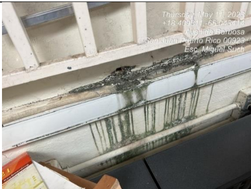
Ilustración 9. Filtración de Agua
