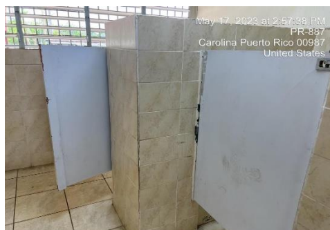
Ilustración 15. Reemplazar puertas de partición por puertas de tolas
