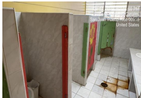
Ilustración 14. Reemplazar puerta de partición por puestas de aluminio y el piso del segundo nivel de ambos baños hay que rellenar y tapar eso drenajes
