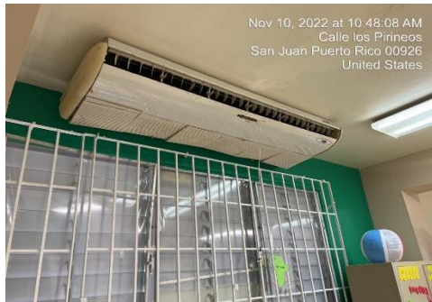
Ilustración 1. Reemplazar A/C en el salón de kínder y el salón que se quemó un poco el A/C y el salón de alado
