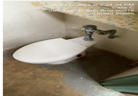
Ilustración 8. Reemplazar inodoros de kínder que sean pequeños
