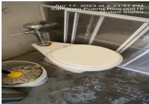
Ilustración 7. Reemplazar inodoros de kínder que sean pequeños
