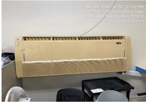
Ilustración 23. Reemplazar A/C 5 tons. Salón #8
