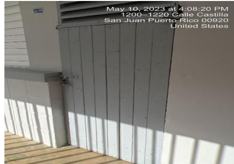
May 10, 2023 at 4:08:20 PM 1200-1220 Calle Castilla San Juan Puerto Rico 00920 United States Ilustración 18. Reemplazar puertas de maderas por puertas de tolas
