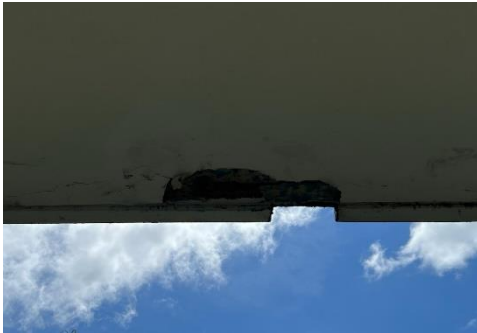
Ilustración 5. Repicar y resanar varillas expuestas
