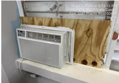
Ilustración 7. Mantenimiento de A/C
