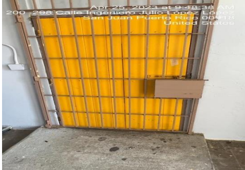
Ilustración 11. Reemplazar puertas de madera por puertas de tolas
