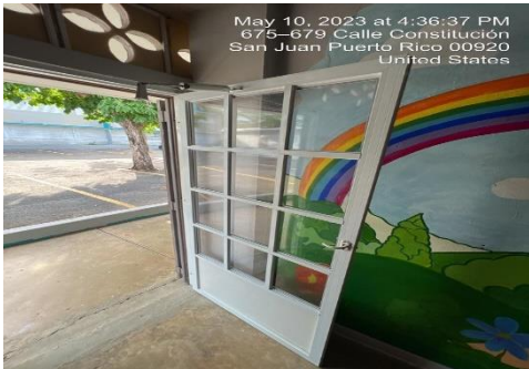
May 10, 2023 at 4:36:37 PM 675-679 Calle Constitución San Juan Puerto Rico 00920 United States Ilustración 21. Reemplazar puertas de screen
