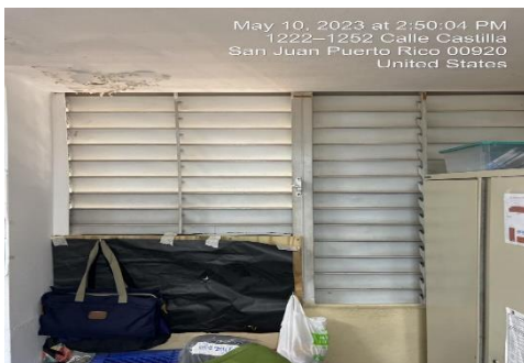
Ilustración 3. Reemplazar ventanas rotas
