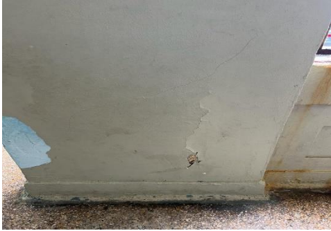
Ilustración 5. Repicar, resanar y tratamiento a varillas expuestas
