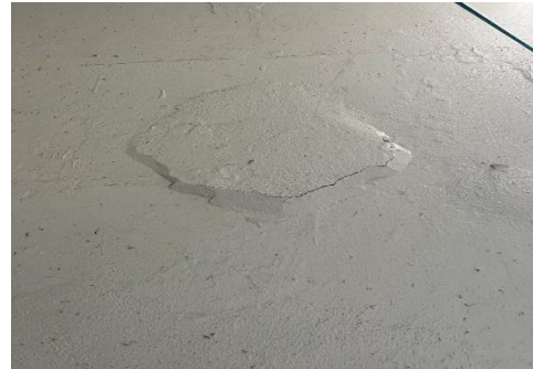
Ilustración 6. Repicar, resanar y tratamiento a varillas expuestas
