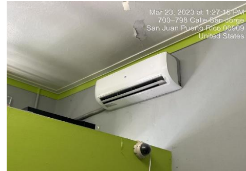
Ilustración 26. Mantenimiento de A/C
