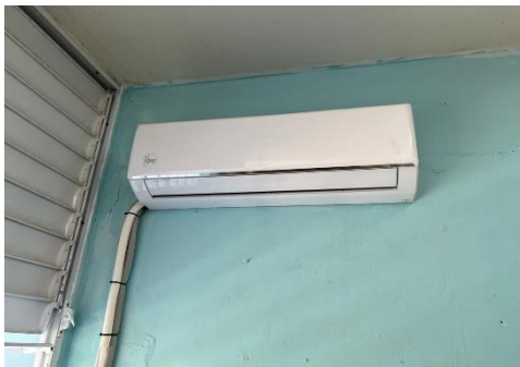
Ilustración 3. Mantenimiento de A/C
