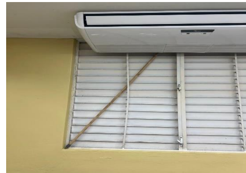
Ilustración 8. Mantenimiento de A/C
