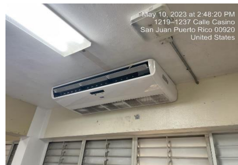
Ilustración 2. Mantenimiento de A/C
