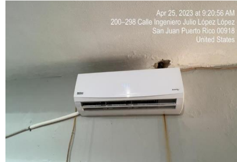
Ilustración 6. Mantenimiento de A/C
