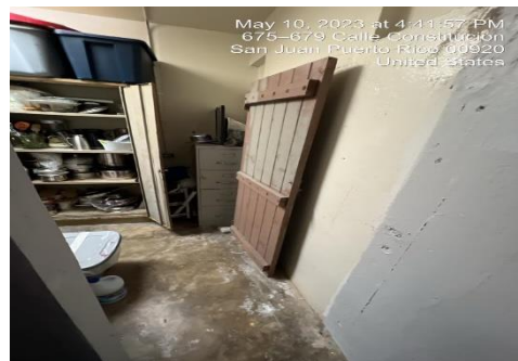
May 10, 2023 at 4:41:57 PM 675-679 Calle Constitución San Juan Puerto Rico 00920 United States Ilustración 22. Reemplazar puerta de madera por puerta de aluminio
