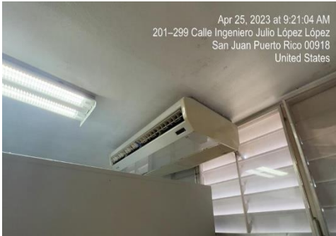
Ilustración 7. Mantenimiento de A/C
