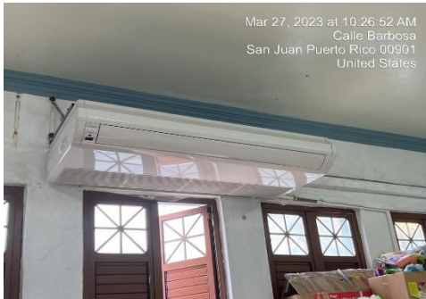
Ilustración 7. Mantenimiento de A/C
