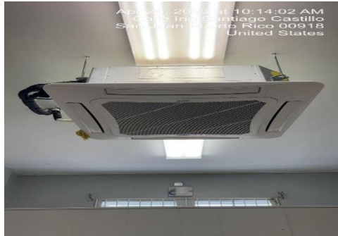
Apr 25, 2023 at 10:14:02 AM Calle Ing Santiago Castillo San Juan Puerto Rico 00918 United States Ilustración 25. Manteniendo de A/C
