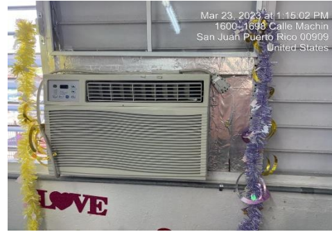
Ilustración 24. Mantenimiento de A/C
