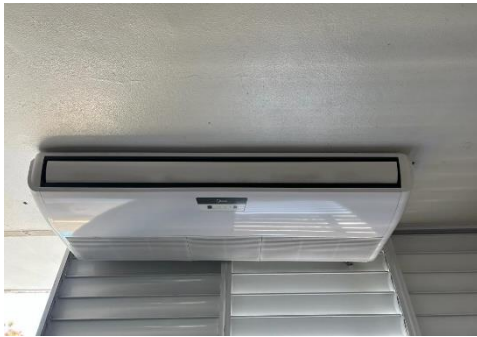
Ilustración 1. Mantenimiento de A/C
