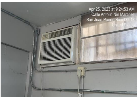
Ilustración 9. Mantenimiento de A/C
