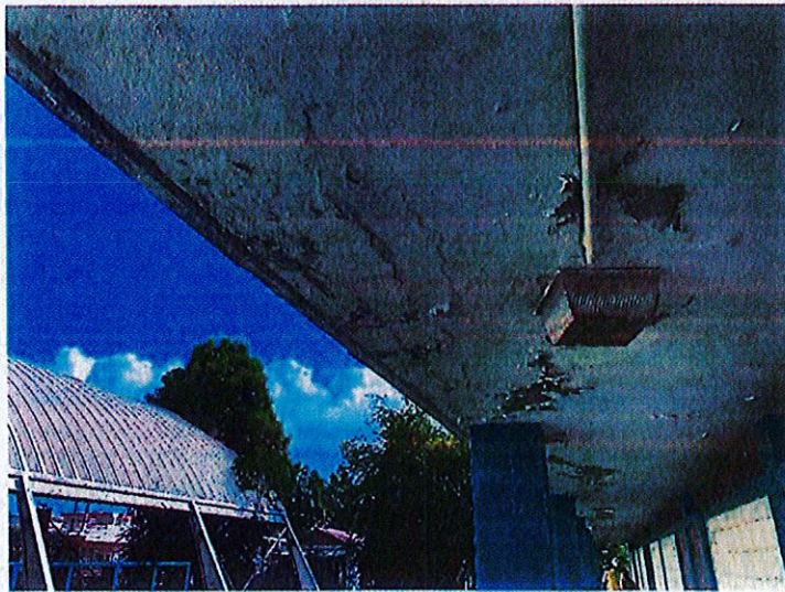
Foto 6: El Edificio #3 tiene grietas y desprendimientos de hormigón donde se puede observar el acero de refuerzo corrido de la loza de techo a través de todo el pasillo.
