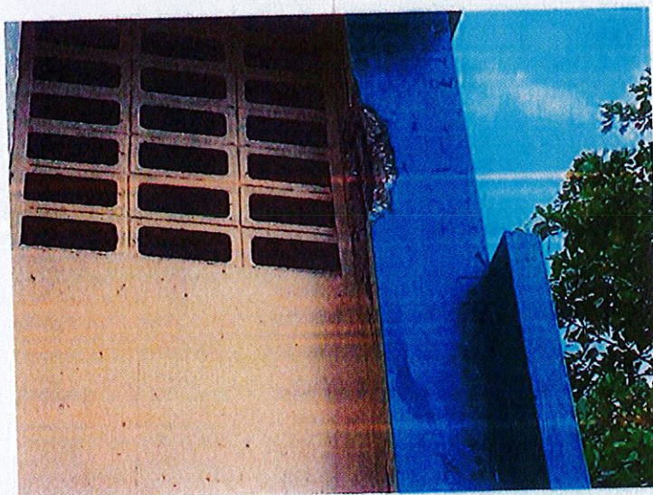
Foto 4: El Edificio #1 tiene columnas con el recubrimiento de hormigón desprendido y se observa el acero de refuerzo corrido.
